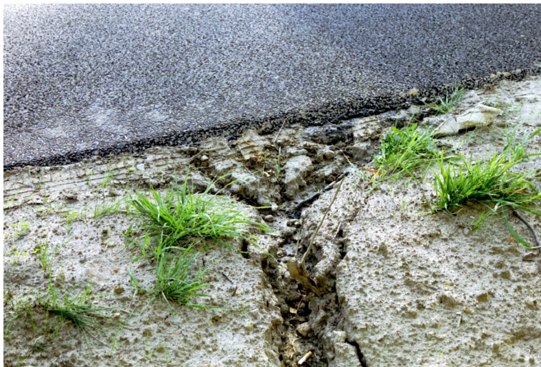
Fot. 2. Zniszczenie skarpy na skutek spływu wody nie ujętej w system odwodnienia nawierzchni (fot. B. Gajewska)
