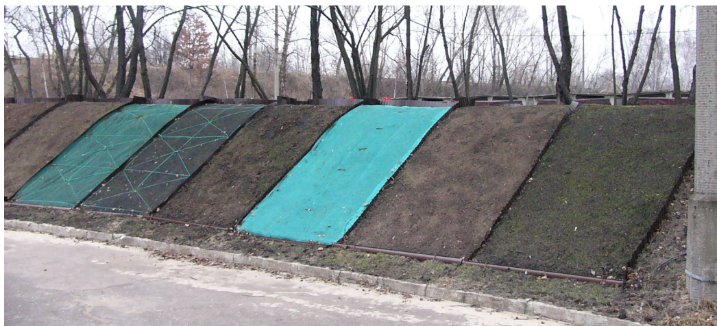
Rys. 59. Widok poletek doświadczalnych w dniu 11 stycznia 2005 (fot. B. Gajewska)
