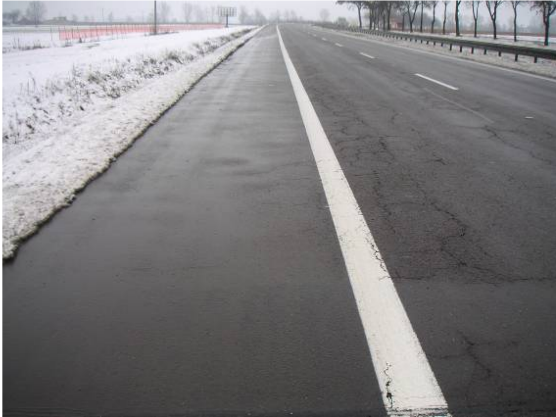
Fot. 2. Spękania blokowe
