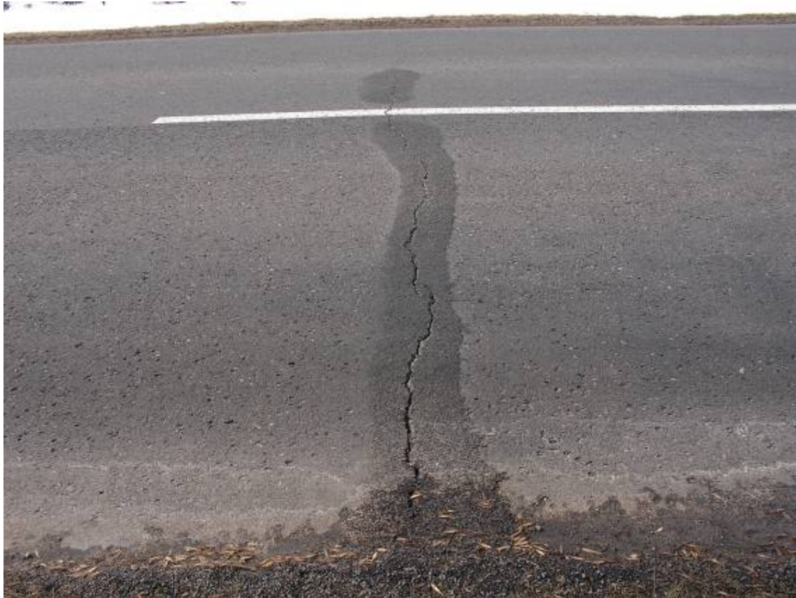
Fot. 1. Pęknięcie pojedyncze
