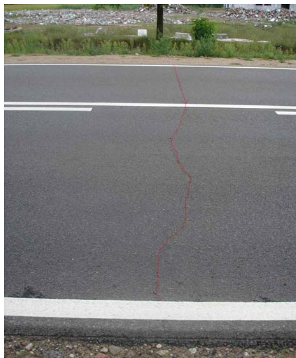
Fotografia 5.6 Spękanie poprzeczne (DK 60)
