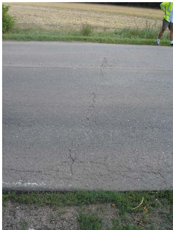
Fotografia 5.13. Spękanie poprzeczne, i obłamanie krawędzi (DK 61)
