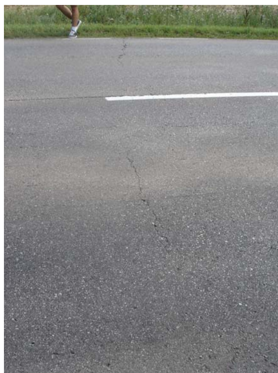
Fotografia 5.14 Spękanie poprzeczne (DK 61)
