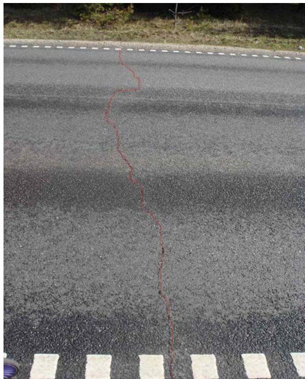
Fotografia 5.9. Spękanie poprzeczne (DK 5/10)
