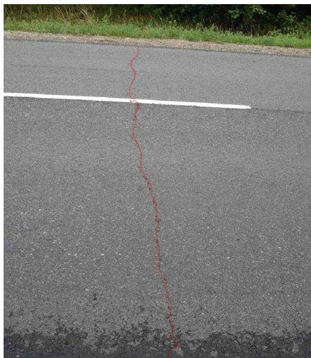
Fotografia 5.5. Spękanie poprzeczne (DK 50)
