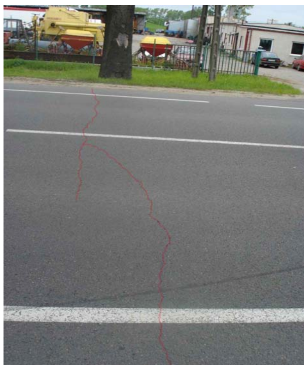
Fotografia 5.7. Spękanie poprzeczne, rozgałęzione (DK 22)
