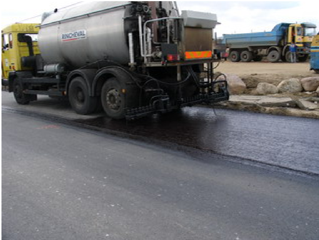
Rysunek 4.6. Widok automatycznej spryskiwarki emulsji asfaltowej do sprysku międzywarstwowego
