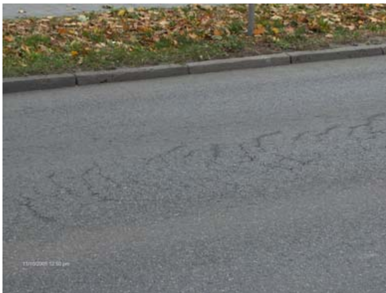
Rys. 2.1. Widok księżycowatych spękań na skutek braku szczepności międzywarstwowej (fot. P. Jaskuła).
