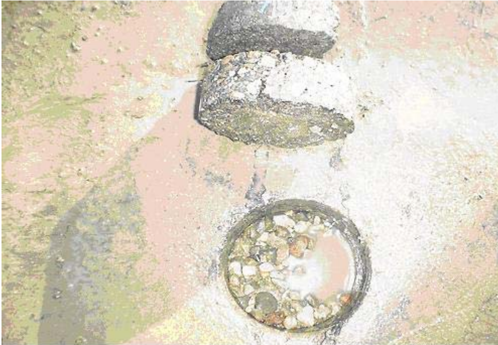
Rysunek 4.1. Widok próbki wyciętej z nawierzchni na gruntach słabonośnych pkt. 19', brak szczepności w nowych warstwach asfaltowych pomiędzy warstwą wiążącą a podbudową.
