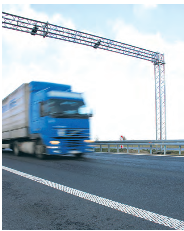
Na bramownicach nad jezdnią montowane są czujniki i kamery.
