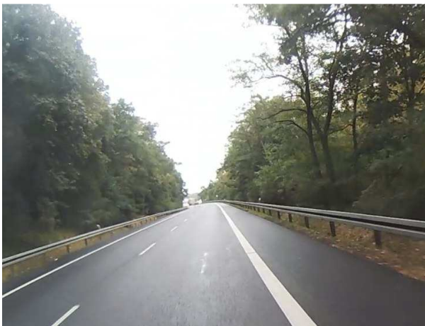
DK5 Las na odcinku Kościan - Śmigiel
