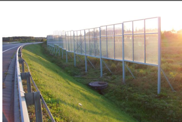
Ekrany akustyczne zlokalizowane wzdłuż drogi krajowej nr 16c, odcinek WN_7_0810_16c o nazwie OLSZTYN-WĘŻEŁ BARCZEWO km 0+000 - 11+707
