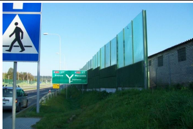
Ekrany akustyczne zlokalizowane wzdłuż drogi krajowej nr 73c, odcinek 933 o nazwie WIŚNIÓWKA-KIELCE, km 0+000 – 3+038
