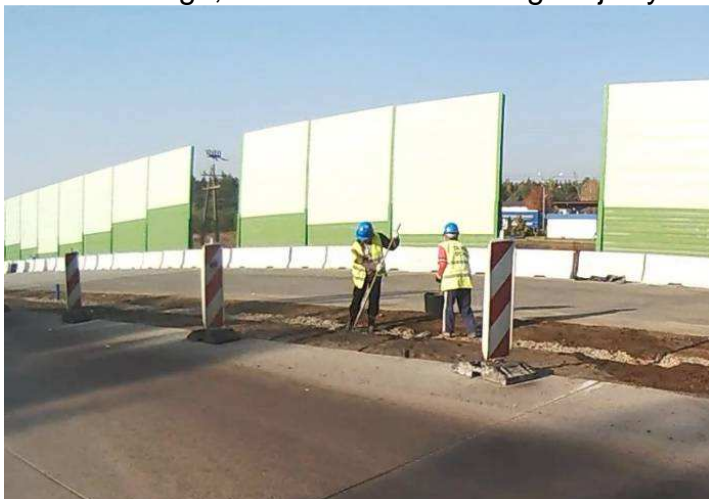
DK 2 – A2 (ekran akustyczny w km 97+600)
