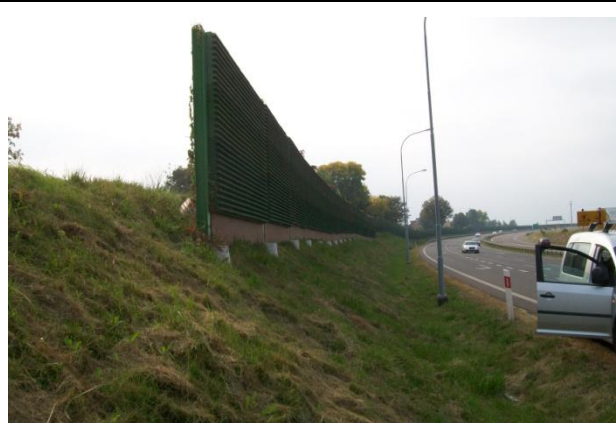
Ekrany akustyczne zlokalizowane wzdłuż drogi krajowej nr 12, odcinek LU_7_0752_12 o nazwie ŚWIDNIK (KRĘPIEC)-PIASKI, km 619+211 – 630+400; 0+000 - 1+395
