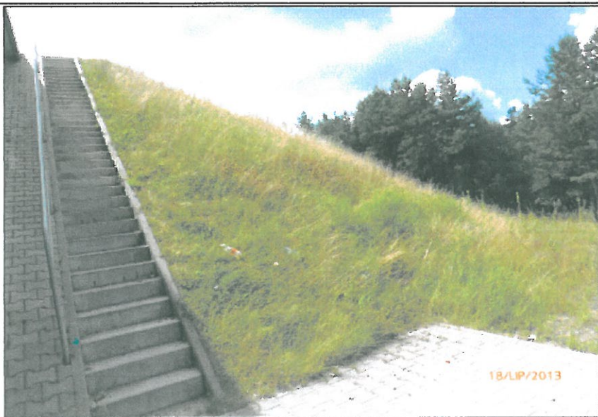
Fot. 2 Schody skarpowe od strony Warszawy. Zanieczyszczenia stożka.
