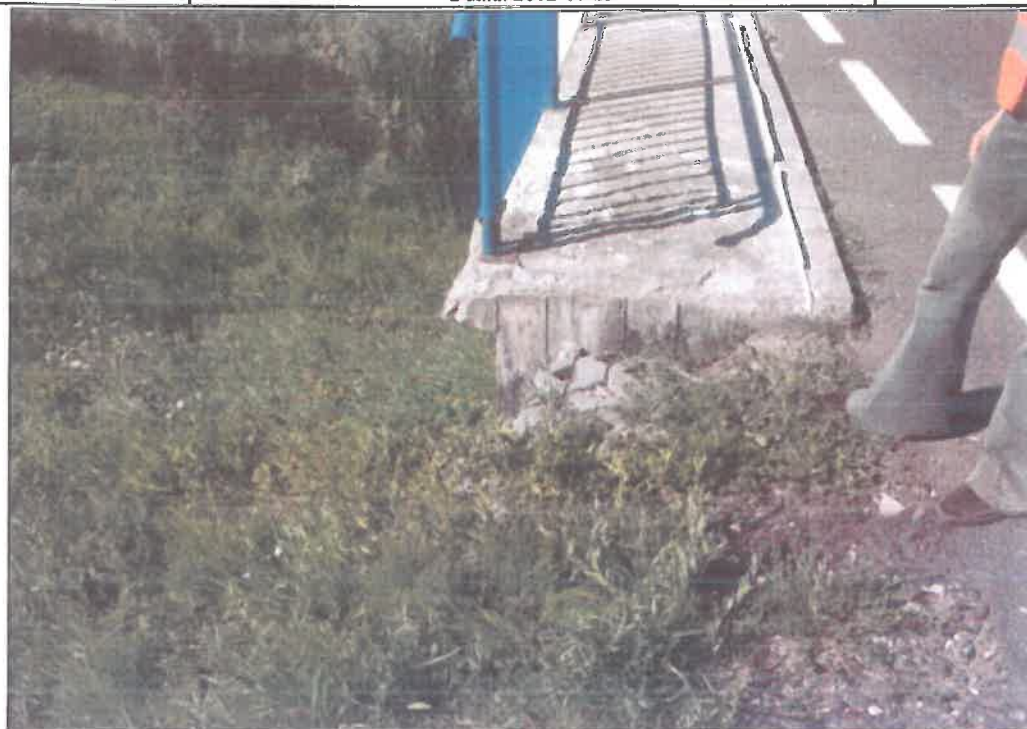
Fot. 5 przemieszczenie płyt ażurowych
