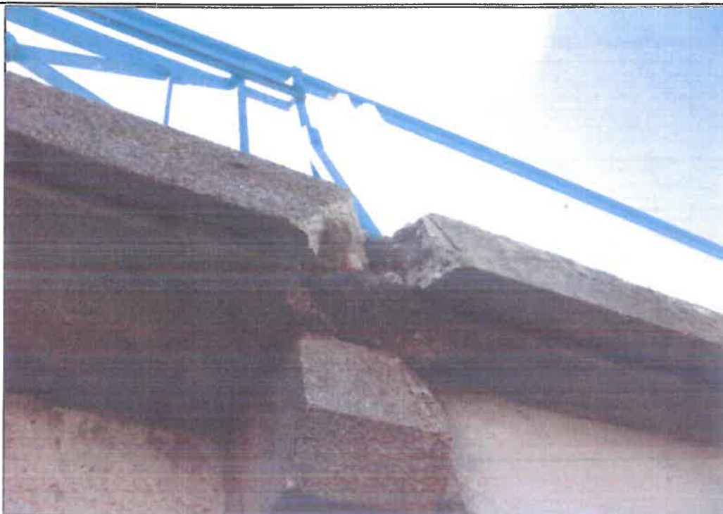
Fot. 6 ubytki gzymsu
