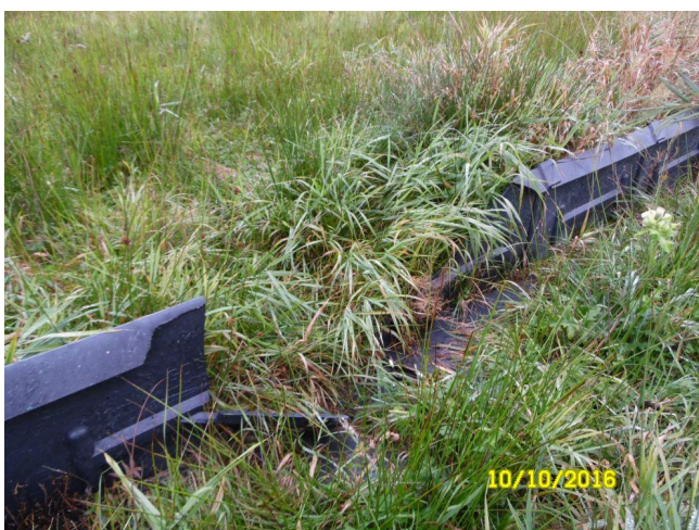
Zbiornik kompensacyjny w km 79+200 P, uszkodzenie ogrodzenia
