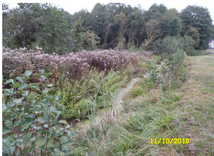
Stanowisko nr 58, system rowów i cieków w km 91+050-91+300 L, obniżony poziom wody
