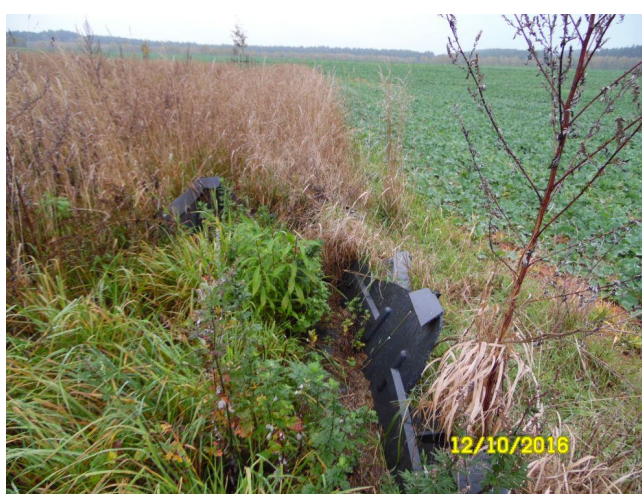
Zbiornik kompensacyjny w km 30+500 L, uszkodzenie ogrodzenia
