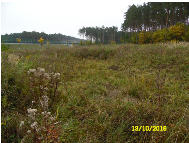
Zbiorniki kompensacyjne w km 61+500 P, wyschnięty
