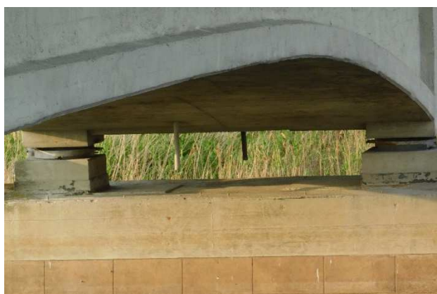
Fot 3.28 Łożyska na podporze P3. Występuje miejscowa korozja powierzchniowa.
