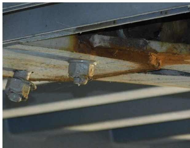
Fot 3.53 Widok na dolny węzeł konstrukcji. Widoczna korozja blachy poziomej. Z lewej strony widoczna poluzowana śruba.
