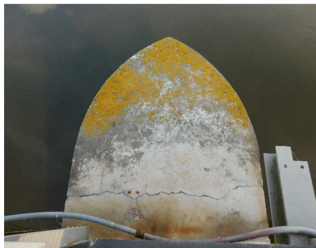
Fot 3.22 Widok na filar P4 od góry. Widoczne poprzeczne zarysowanie ławy podłożyskowej od strony górnej wody.
