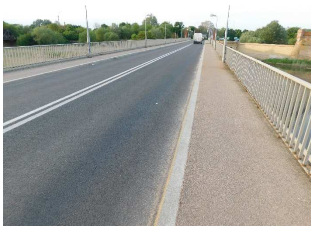
Fot 3.42 Nawierzchnia chodnika od strony górnej wody. Stan dobry.
