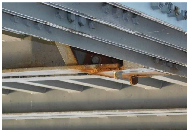
Fot 3.54 Widok na dolny węzeł konstrukcji. Widoczna korozja blachy poziomej oraz korozja łączników.
