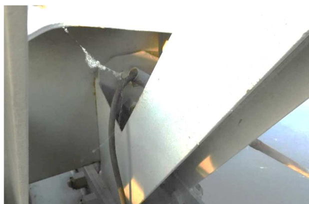
Fot 3.62 Widok na początek odspojonej osłonki kabla zasilającego sygnalizator.
