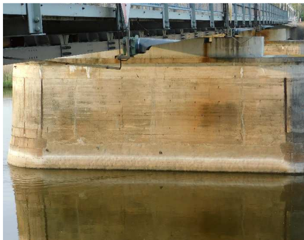
Fot 3.61 Widok ogólny na filar P5 od strony Niemiec. Na powierzchni występują zacieki, lokalne wyługowania rozpuszczalnych składników betonu, odsłonięte lokalnie pojedyncze pręty.
