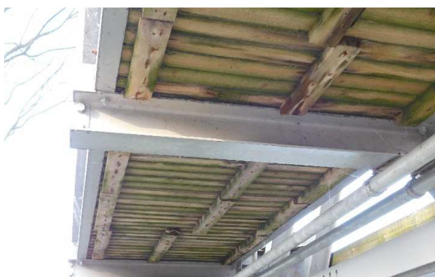
Fot 3.62 Widok na spód drewnianej nawierzchni chodnika od strony dolnej wody. Widoczna powierzchniowa korozja biologiczna drewna.
