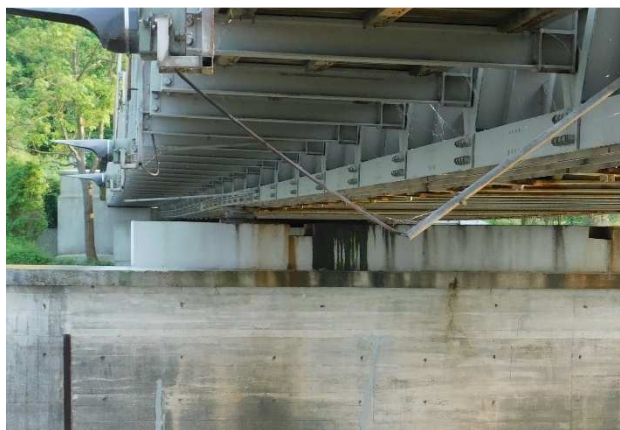
Fot 3.62 Odspojona stalowa osłodka kabla zawisa na kablu zasilającym sygnalizatora.
