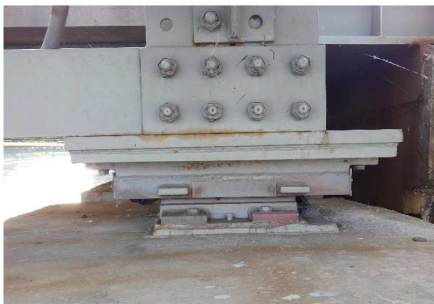
Fot 3.66 Widok na jedno z łożysk na filarze P4. Stan ogólnie dobry.
