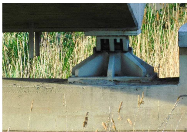
Fot 3.27 Łożysko na filarze P2. Występuje miejscowa korozja powierzchniowa.
