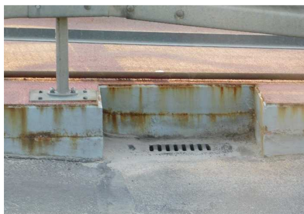
Fot 3.62 Korozja powierzchniowa na stalowym krawężniku na początku obiektu od strony Polski.
