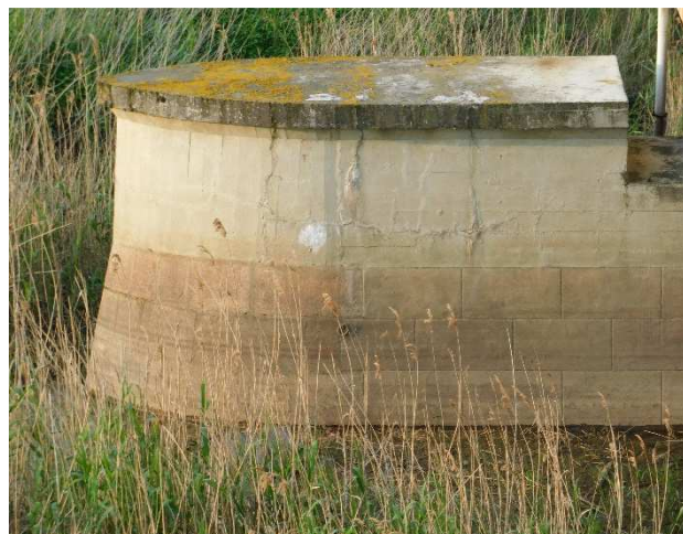
Fot 3.20 Widok na część filara P3 od strony Niemiec i dolnej wody. Pod ławą podłożyskową widoczna jest miejscowo złuszczone powierzchnia betonu.
