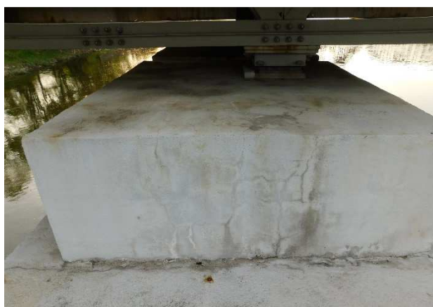
Fot 3.66 Widok na cios podłożyskowy na filarze P6. Widoczne zarysowania betonu.
