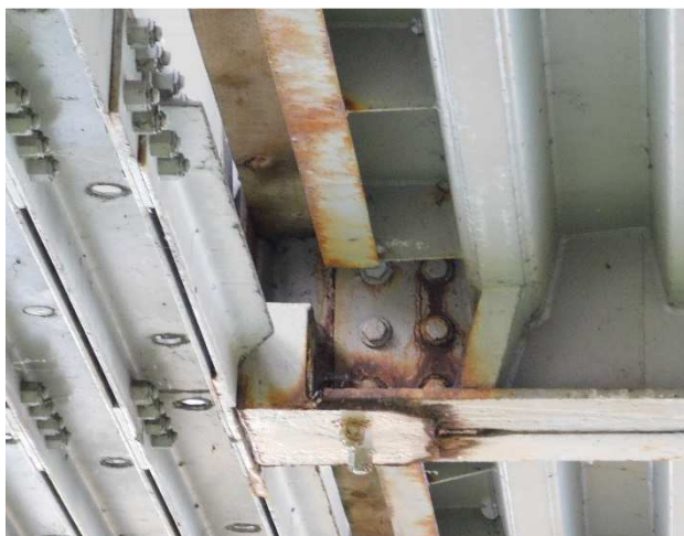
Fot 3.58 Zbliżenie na jeden ze skorodowanych węzłów łączących pomost z dźwigarem od strony dolnej wody.
