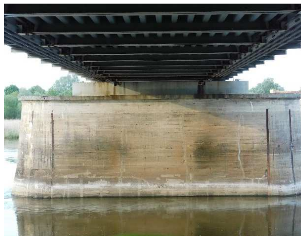
Fot 3.63 Widok ogólny na filar P6 od strony Niemiec. Na powierzchni występują zacieki i lokalne wyługowania rozpuszczalnych składników betonu.
