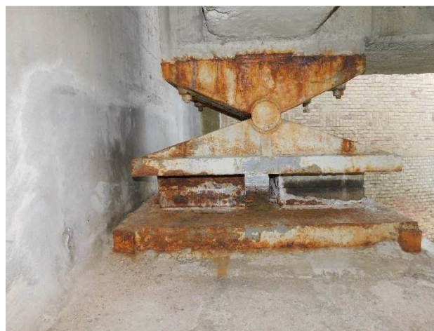
Fot 3.25 Łożysko na przyczółku P1 od strony górnej wody. Widoczne początki korozji wżerowej.
