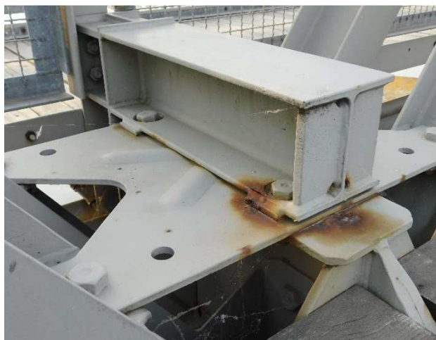
Fot 3.52 Lokalna korozja w węźle dolnym kratownicy.
