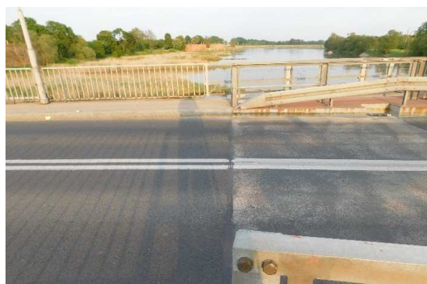
Fot 3.31 Przekrycie dylatacji z góry między częścią żelbetową i stalową.
