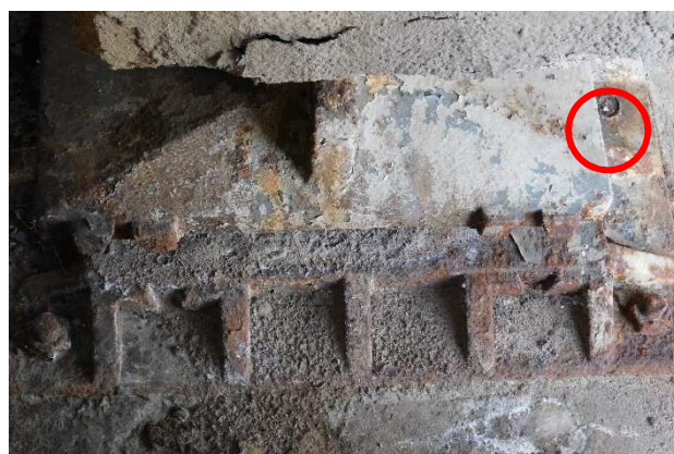
Fot 3.29 Łożysko na podporze P4. Widoczne zanieczyszczenie i korozja powierzchniowa. Z prawej strony widoczny brak śruby mocującej blachę dolną (zakreślone czerwonym okręgiem).
