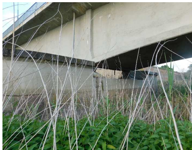
Fot 3.18 Widok na filar P2 od strony Niemiec. Widoczny dobry stan podpory.
