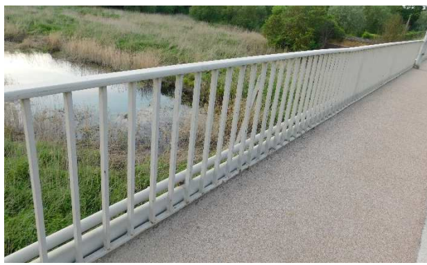
Fot 3.41 Balustrada przy chodniku od strony dolnej wody. Miejscowo występuje korozja powierzchniowa.
