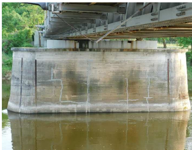
Fot 3.62 Widok ogólny na filar P6 od strony Polski. Występują zacieki na powierzchni betonu i lokalne zarysowanie betonu pod ławą podłożyskową w części środkowej.
