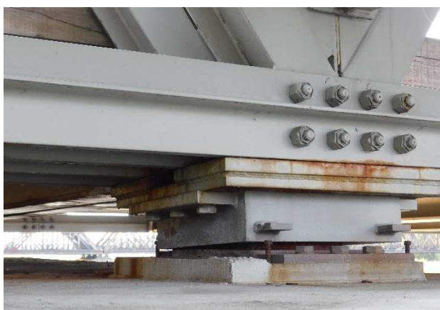
Fot 3.66 Widok na jedno z łożysk na filarze P6. Widoczna korozja powierzchniowa na płycie górnej.
