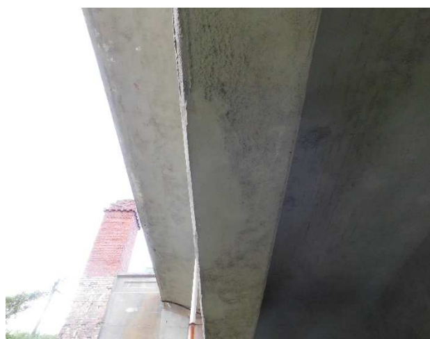
Fot 3.10 Widok na spód belki prawej w prześle 1. Widoczne są ślady napraw belki.
