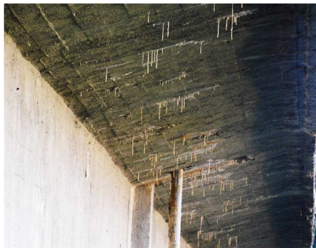
Fot 3.6 Strefa intensywniejszych przecieków na spodzie wspornika podchodnikowego. Widoczne liczne stalaktyty.
