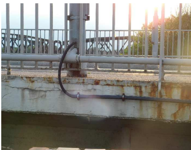
Fot 3.11 Widok na gzyms po stronie górnej wody. Widoczne spękania powierzchniowej warstwy betonu i rdzawe zacieki.
