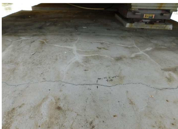
Fot 3.66 Spękana górna powierzchnia ciosu podłożyskowego filara P5.
