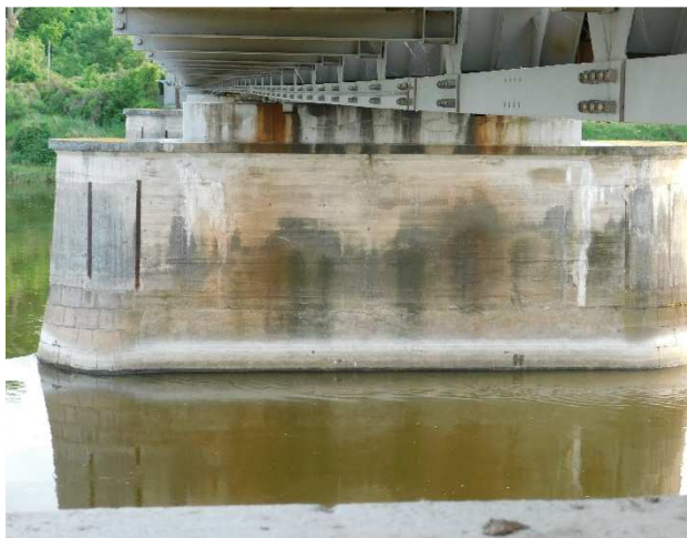
Fot 3.60 Widok ogólny na filar P5 od strony Polski. Na powierzchni występują zacieki i lokalne wyługowania rozpuszczalnych składników betonu.
