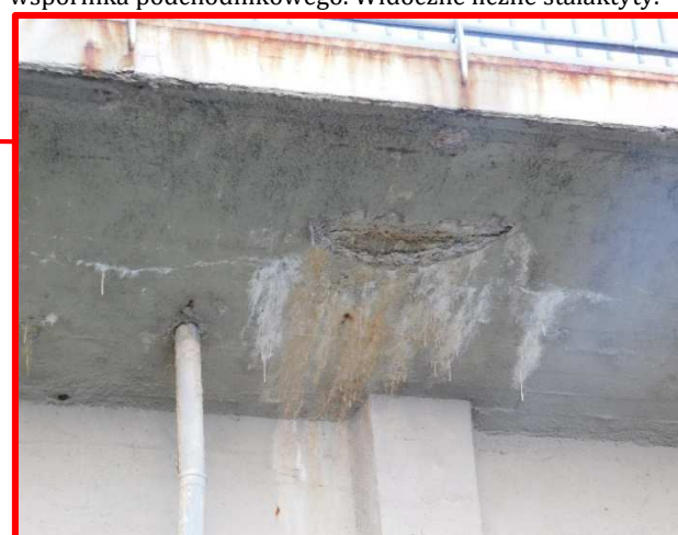
Fot 3.8 Przeciek przez konstrukcję chodnika i powierzchniowy ubytek betonu na filarem nr 1 od strony dolnej wody.
