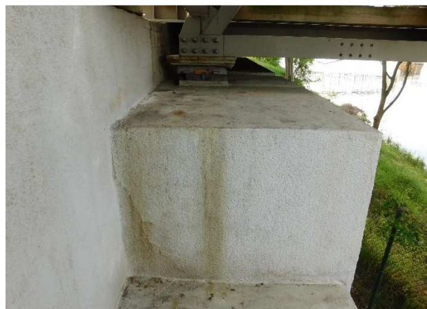
Fot 3.66 Cios podłożyskowy na przyczółku P7. Stan ciosu poza zanieczyszczeniami na górnej powierzchni jest ogólnie dobry.
