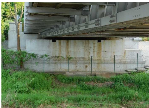
Fot 3.64 Widok ogólny na przyczółek P7. Na powierzchni korpusu występują powierzchniowe spękania betonu i nieestetyczne zacieki.
