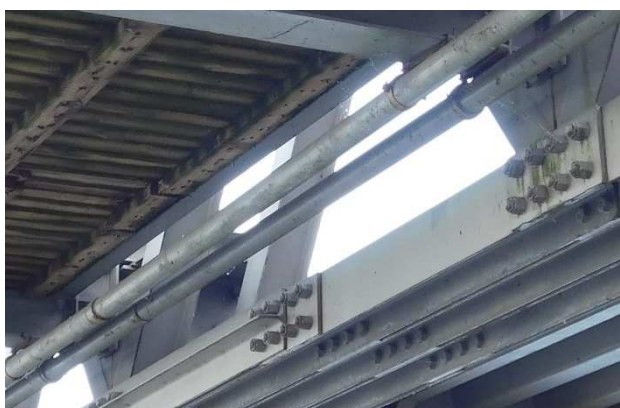
Fot 3.62 Widok na stalowe osłony kabli przebiegające pod dźwigarem kratownicowym.
