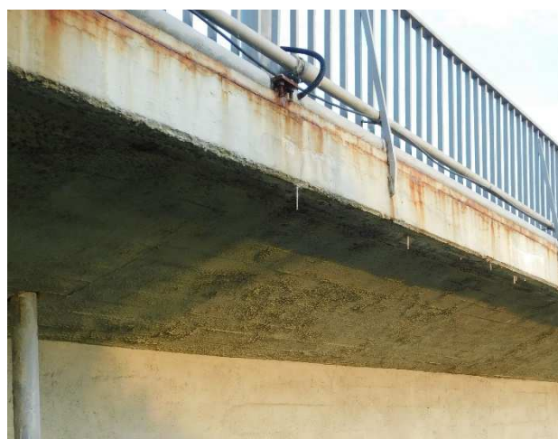
Fot 3.12 Widok na gzyms po stronie dolnej wody. Widoczne rdzawe zacieki na powierzchni gzymsu.
