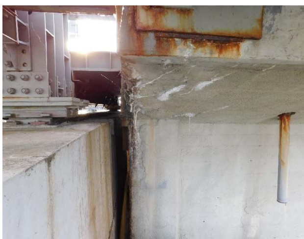
Fot 3.9 Zdegradowany beton elementów konstrukcyjnych przy dylatacji między częścią stalową i żelbetową.
