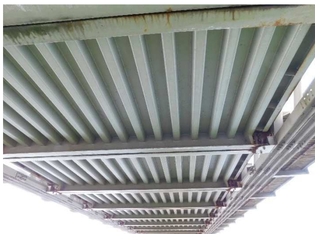
Fot 3.56 Widok ogólny na konstrukcję pomostu. Widoczna korozja w każdym węźle łączącym pomost z dźwigarem.
