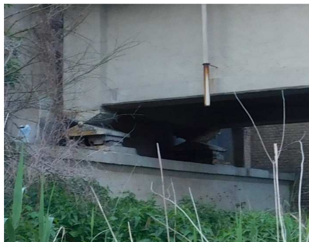
Fot 3.16 Widok na korpus przyczółka P1 od strony dolnej wody. Widoczny dobry stan podpory.
