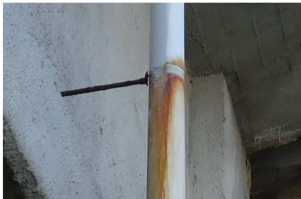
Fot 3.35 Brak łącznika rury spustowej z powodu całkowitej korozji.
