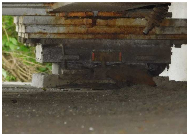
Fot 3.66 Widoczne zanieczyszczenia na powierzchni ciosu przyczółka P7.
