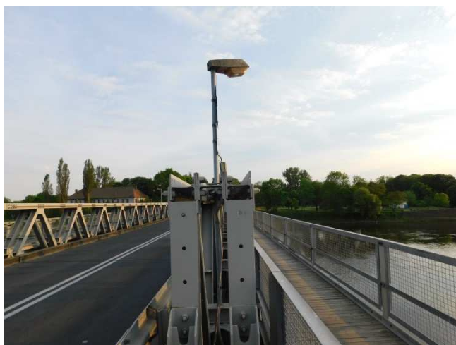
Fot. 2.25 Widok latarni – oświetlenie obiektu (przęsło 6)
