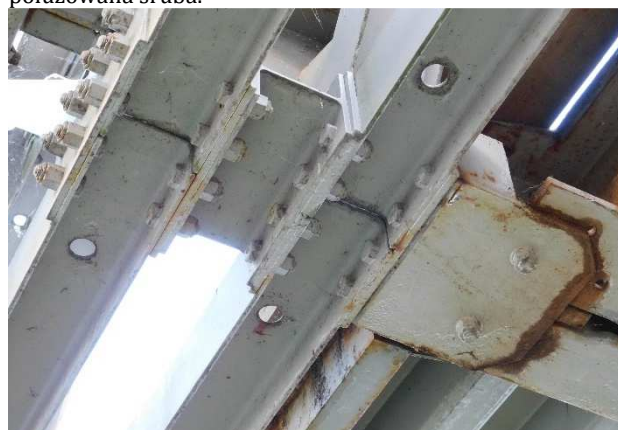
Fot 3.55 Widok na węzeł dolny od spodu. Widoczna korozja na obrzeżu blachy poziomej.
