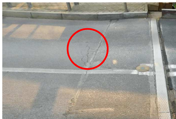
Fot 3.62 Lokalne spękanie nawierzchni jezdni na dojeździe przy dylatacji.
