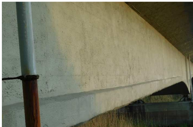
Fot 3.34 Z lewej strony widoczna skorodowana rura spustowa.
