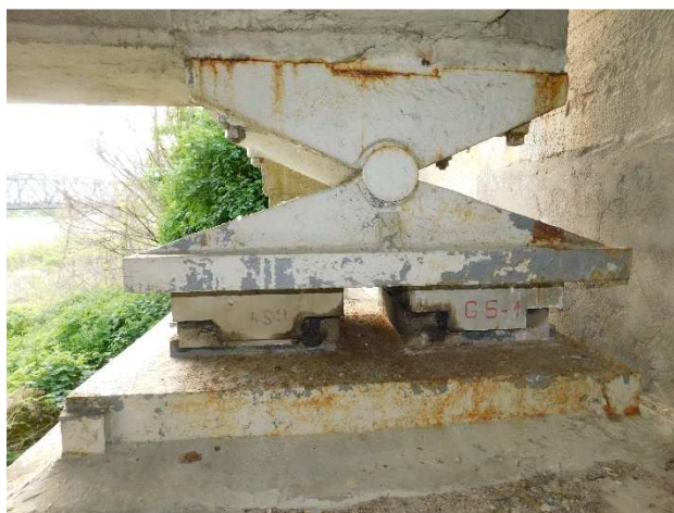
Fot 3.24 Łożysko na przyczółku P1 od strony dolnej wody. Widoczne ubytki powłoki antykorozyjnej i korozja powierzchniowa.
