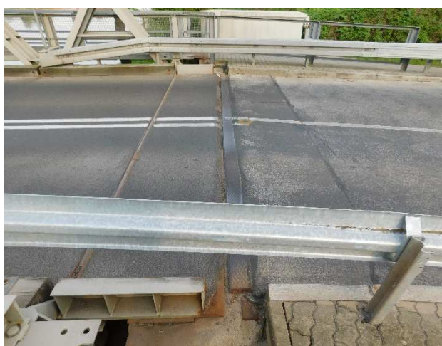
Fot 3.63 Widok na urządzenie dylatacyjne nad przyczółkiem P7 w widoku od góry. Stan dobry.
