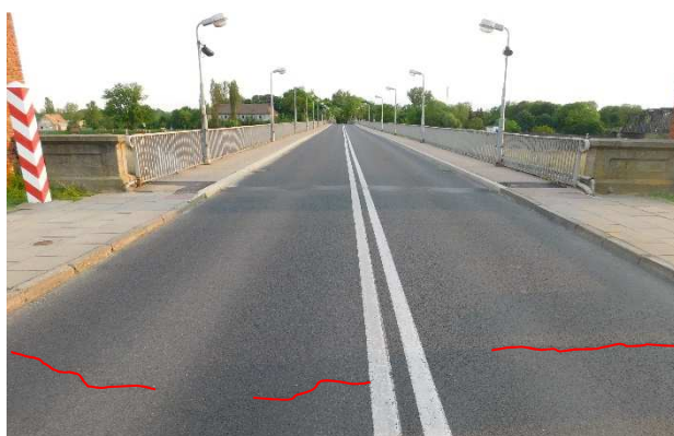
Fot 3.39 Nawierzchnia jezdni na dojeździe do obiektu od strony Polski. Występują lokalne powierzchniowe zarysowania nawierzchni.
