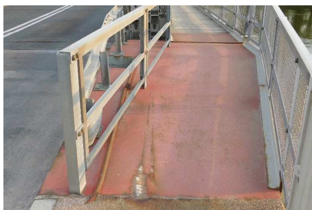
Fot 3.62 Dojście do chodnika od strony Polski i dolnej wody. Widoczny zaciek korozyjny na nawierzchni z żywicy.
