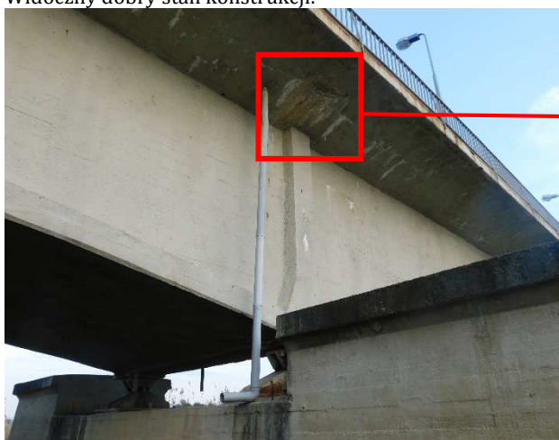
Fot 3.7 Widok na spód wspornika nad filarem P2. Widoczny zakres zacieków na spodzie wspornika.
