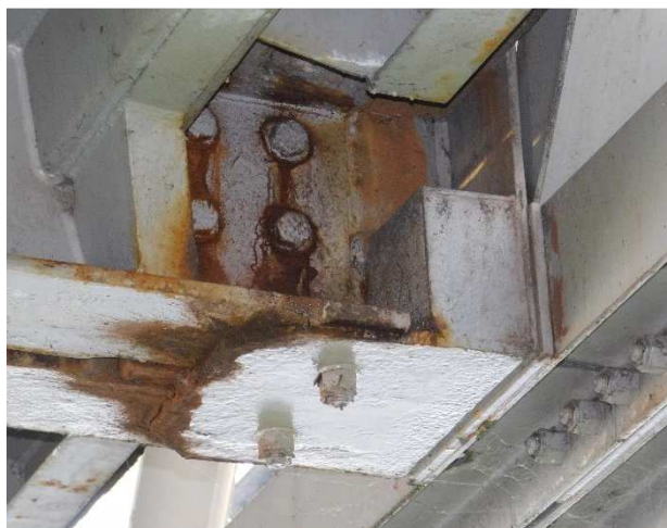
Fot 3.59 Zbliżenie na jeden ze skorodowanych węzłów łączących pomost z dźwigarem od strony górnej wody.
