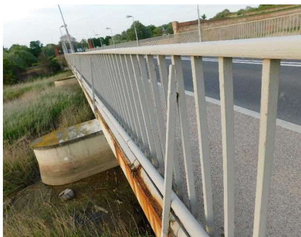
Fot 3.44 Widok na urządzenia obce pod chodnikiem od strony dolnej wody. Widoczna miejscowa korozja powierzchniowa rur.
