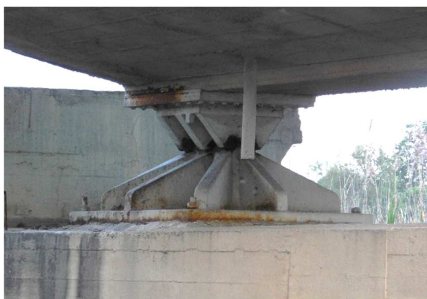
Fot 3.26 Łożysko na filarze P2. Widoczna miejscowa korozja powierzchniowa.
