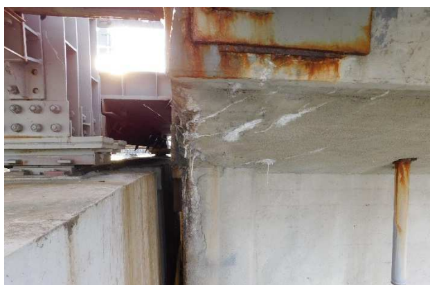
Fot 3.30 Degradacja betonu na zakończeniu przęsła żelbetowego w rejonie dylatacji między częścią żelbetową i stalową.
