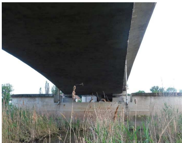
Fot 3.21 Widok na filar P3 od strony Polski. Widoczny dobry stan podpory.
