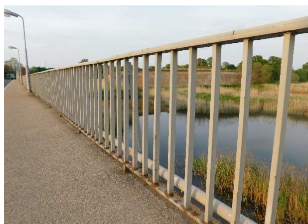
Fot 3.43 Balustrada przy chodniku od strony górnej wody. Widoczna miejscowa korozja powierzchniowa, w szczególności w dolnej części balustrady.
