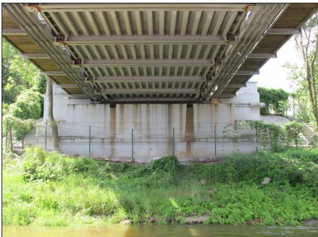
Rys. 6.24. Przyczółek P7. Widok pod strony Polski. Widoczne rozległe zacieki rdzawe pochodzące z niszy podłożyskowej
