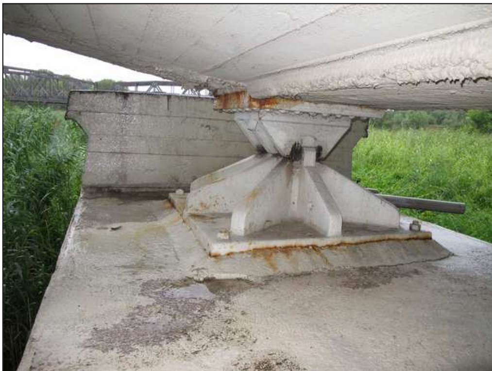
Rys. 6.7. Filar P2. Widok niszy podłożyskowej oraz łożyska od strony dolnej wody. Widoczne liczne zacieki korozyjne w sąsiedztwie elementów łożyska oraz zaleganie wody na niszy na skutek niewłaściwie wykonanego odwodnienia przęsła
