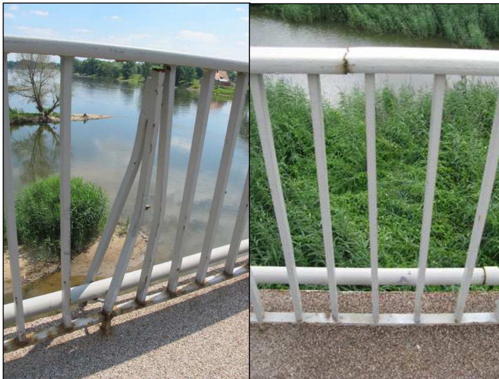
Rys. 5.6. Deformacja słupków balustrady oraz pęknięcie pochwyty od strony górnej wody
