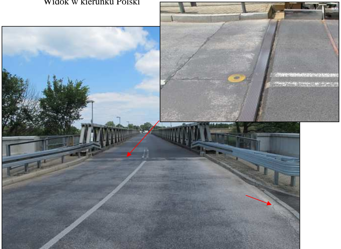
Rys. 5.15. Pojedyncze pęknięcie nawierzchni na dojeździe od strony niemieckiej oraz drobne ubytki warstwy ścieralnej przy wjeździe na obiekt
