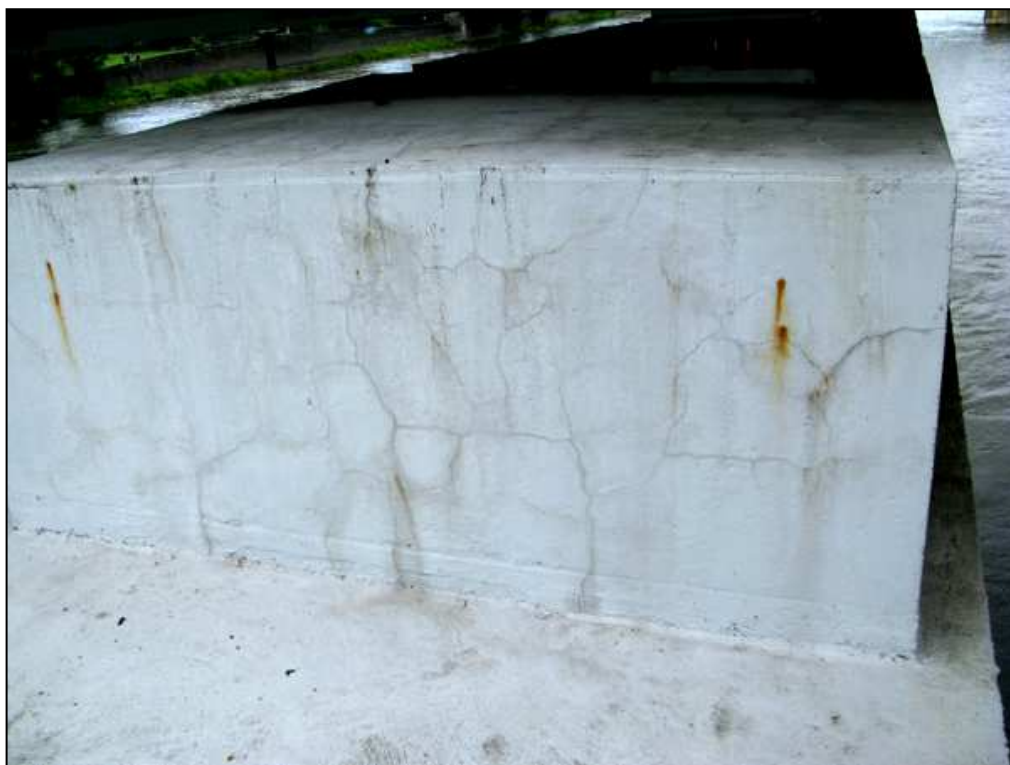
Rys. 6.22. Liczne spękania na powierzchniach ławy podłożiskowego filara P5
