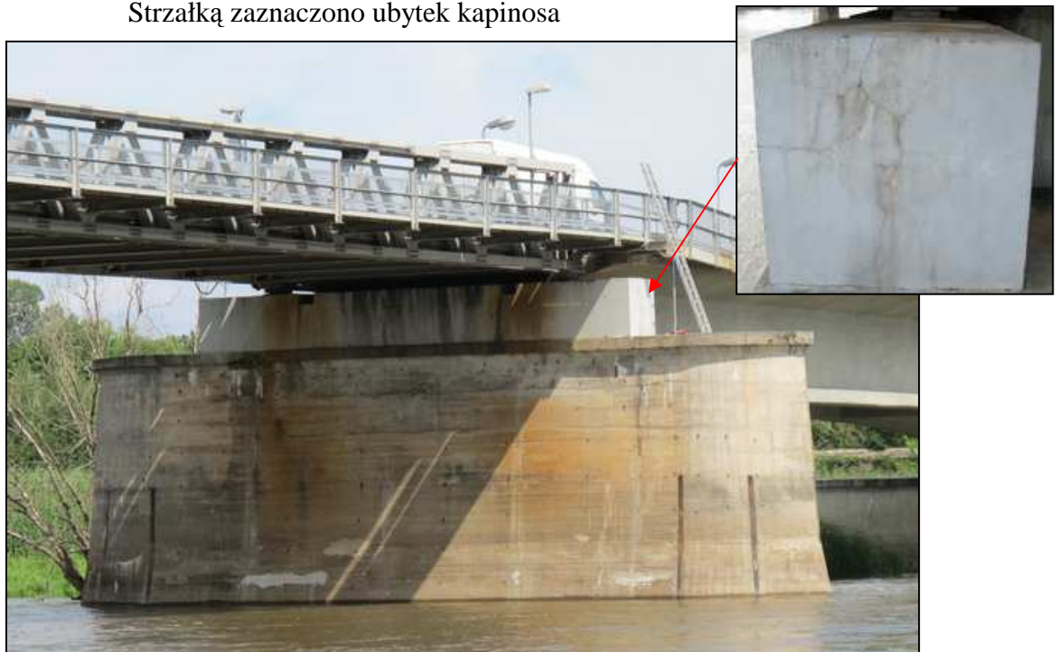
Rys. 6.15. Widok na filar P4 od strony Niemiec / górnej wody. Widoczne liczne spękania powierzchni betonowej, połączone z intensywnymi wykwitami wapiennymi oraz zanieczyszczenia betonu. Na ciosie podłożyskowym widoczne spękania i intensywne zacieki rdzawe
