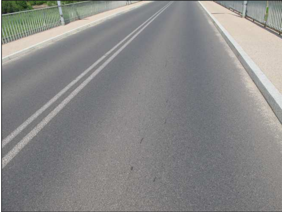
Rys. 5.2. Stan techniczny nawierzchni na części żelbetowej mostu jest bardzo dobry. Występują jedynie drobne zanieczyszczenia wzdłuż krawężników. Widok w kierunku Polski
