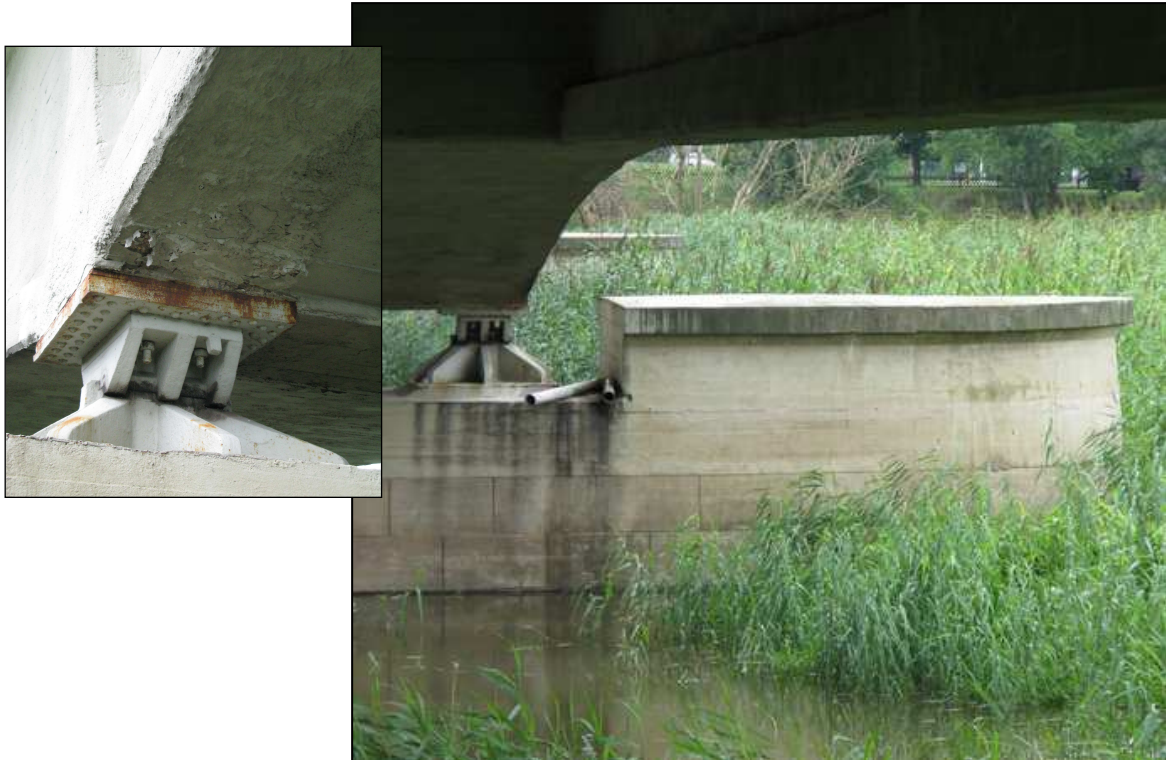
Rys. 6.8. Filar P2. Widok od strony przyczółka P1. Widoczna zerwana rura spustowa odwodnienia przęsła; zbliżenie na łożysko od strony dolnej wody
