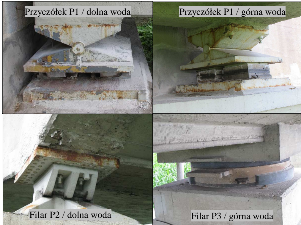
Rys. 5.12. Korozja elementów łożysk oraz ubytki ich warstw antykorozyjnych. Nad łożyskiem filara P2 widoczne są drobne ubytki warstw naprawczych betonu
