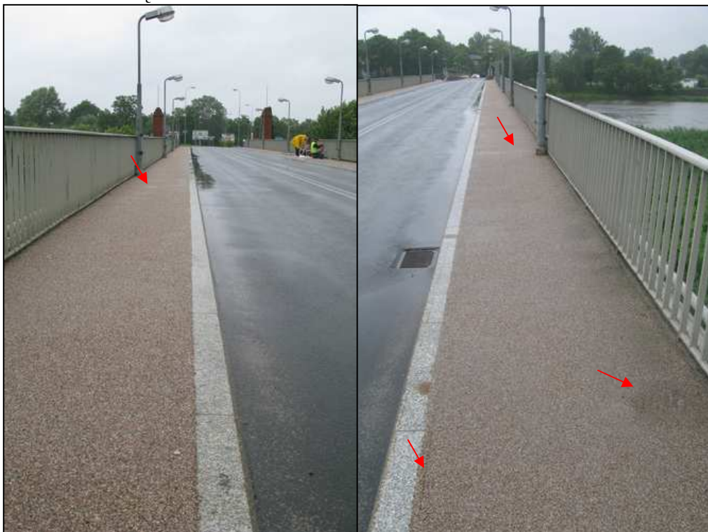
Rys. 5.3. Zaleganie wody w osi odwodnienia na skutek niewielkiego spadku podłużnego oraz częściowej niedrożności wpustów. Zaznaczono również rysę podłużną oraz zastoiska wody na chodnikach będące skutkiem zbyt małego spadku poprzecznego. Lewe zdjęcie - widok w kierunku Polski, prawe zdjęcie - widok w kierunku Niemiec
