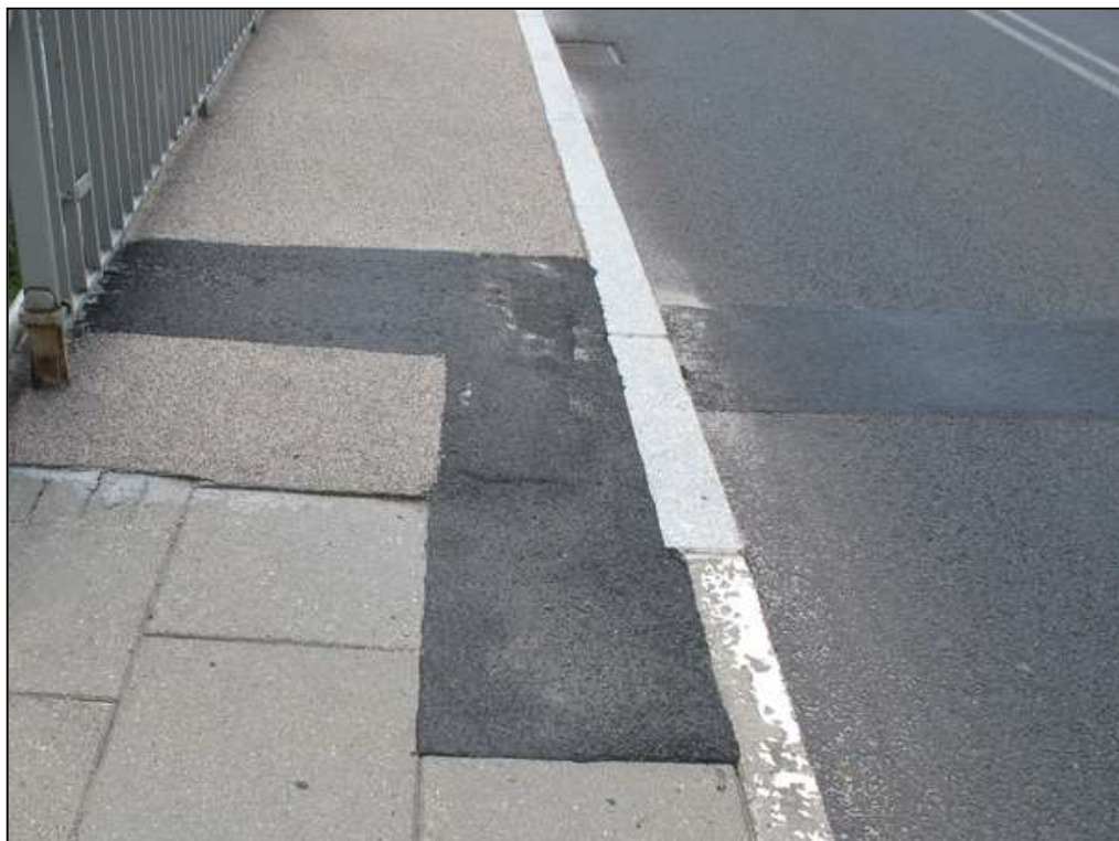
Rys. 5.11. Niewielkie deformacje przekrycia dylatacyjnego na chodniku od strony Polski / górnej wody
