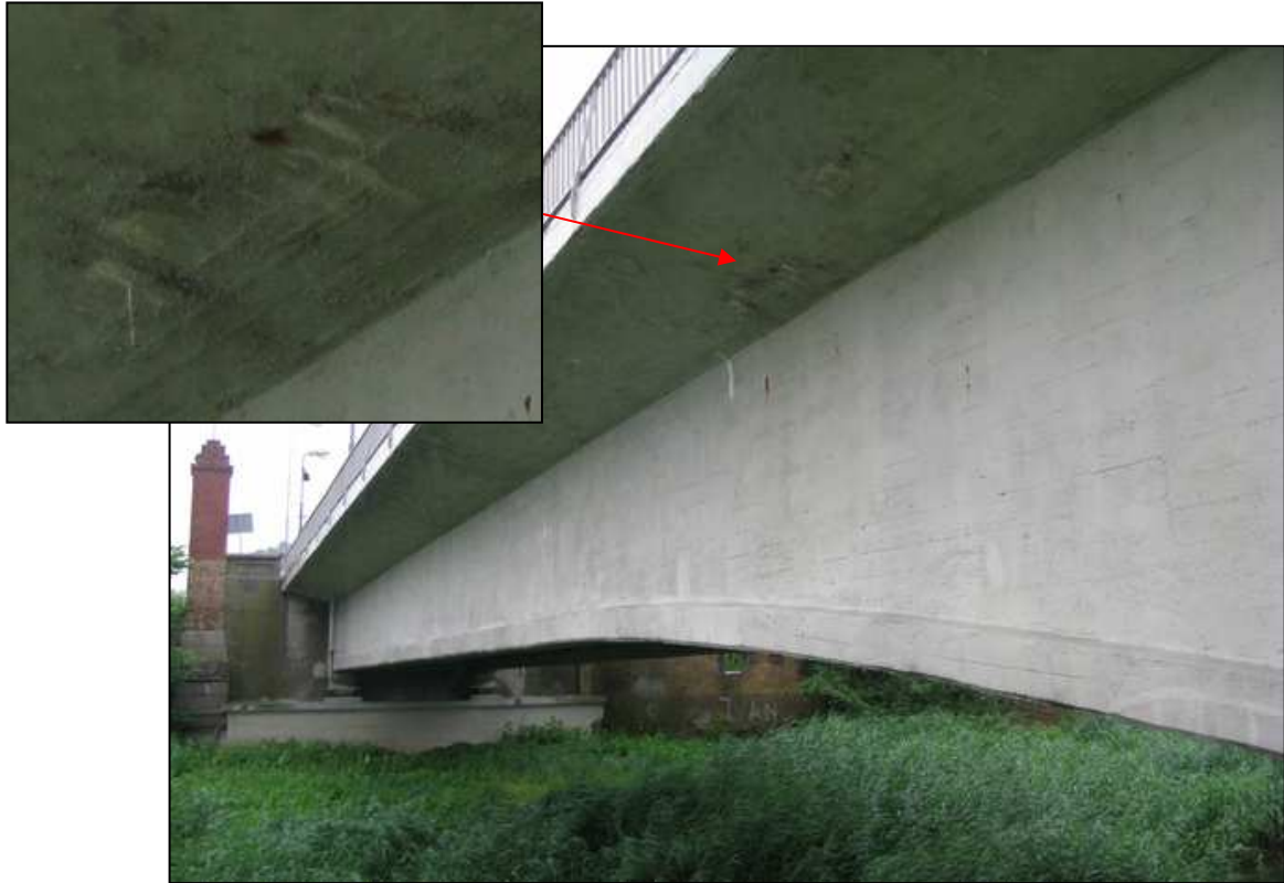
Rys. 5.10. Stare rysy połączone z wykwitami wapiennymi na spodzie wsporników podchodnikowych. W czasie długotrwałych opadów deszczu nie stwierdzono przesączania się wody przez izolację
