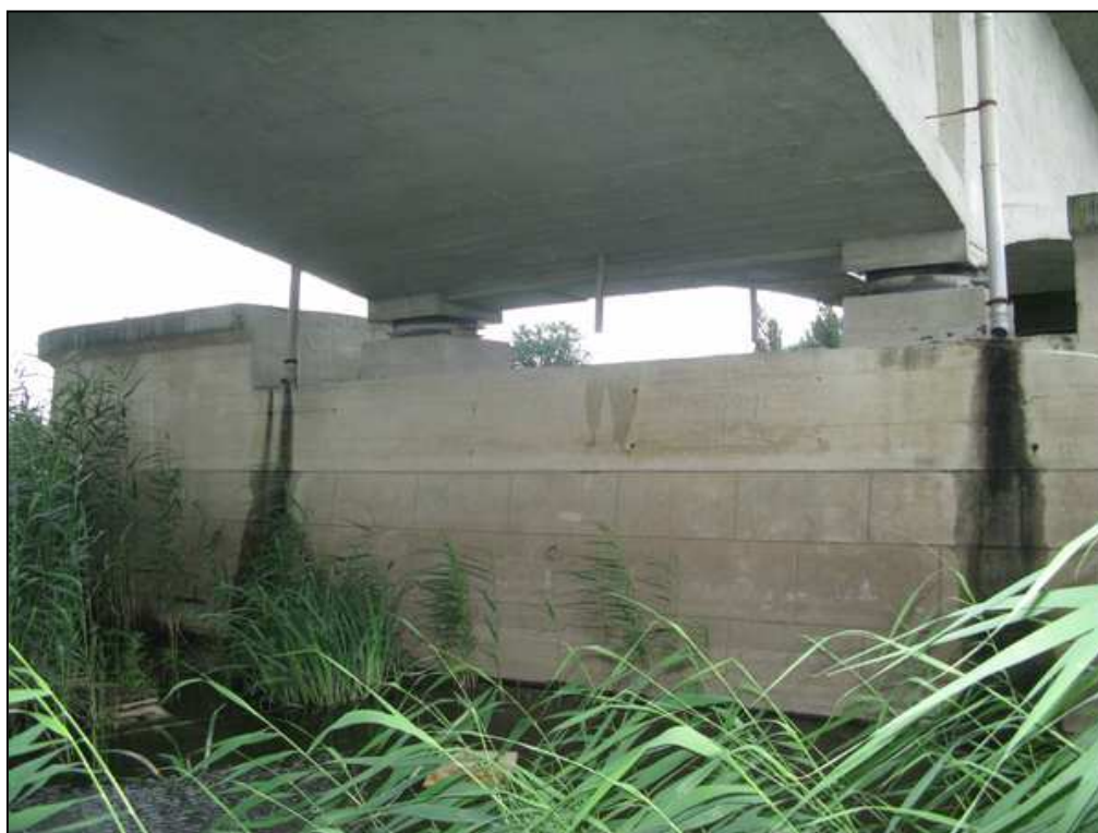
Rys.5.7. Zbyt krótkie kolanka na zakończeniach rur spustowych powodują zaciekanie wody opadowej na niszę podłożyskową. Filar P3 – widok od strony Polski
