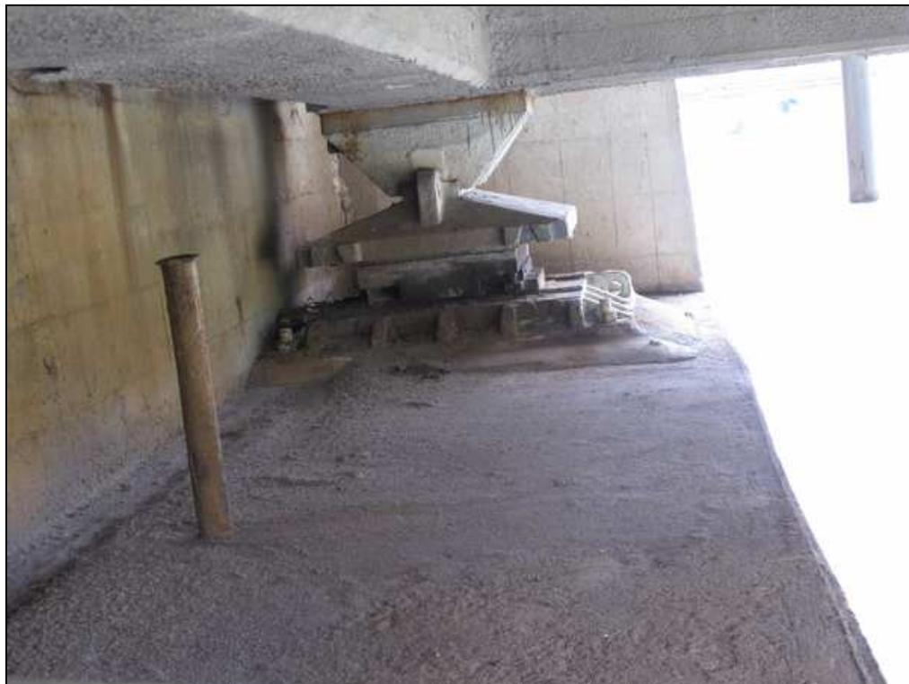
Rys. 5.13. Łożysko na filarze P4 od strony dolnej wody. Widoczne zanieczyszczenie powierzchni ślizgowych łożyska piaskiem pochodzącym z zimowego utrzymania mostu
