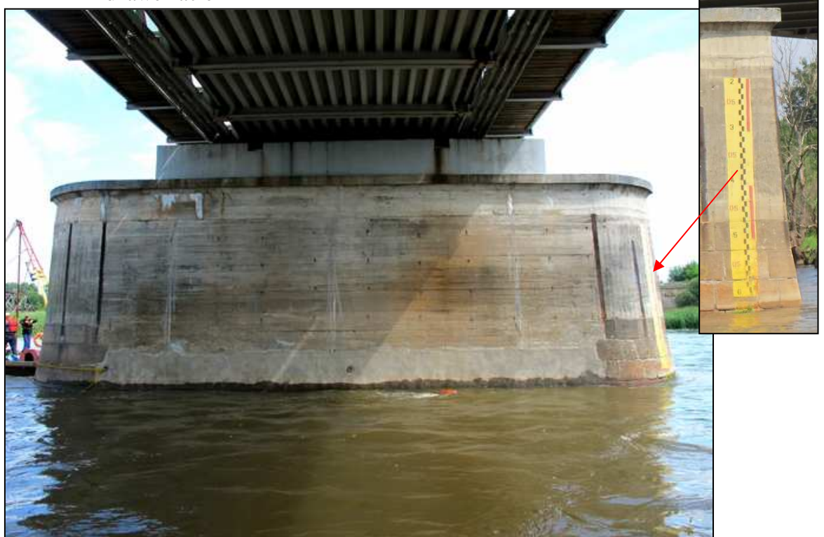
Rys. 6.18. Filar P5, widok od strony Niemiec. Od strony górnej wody (strona prawa) widoczny jest wodowskaz żeglugowy. Widoczne zacieki wapienne oraz odbarwienia betonu. Na powierzchni ciosu podłożiskowego widoczne są intensywne rdzawe zacieki
