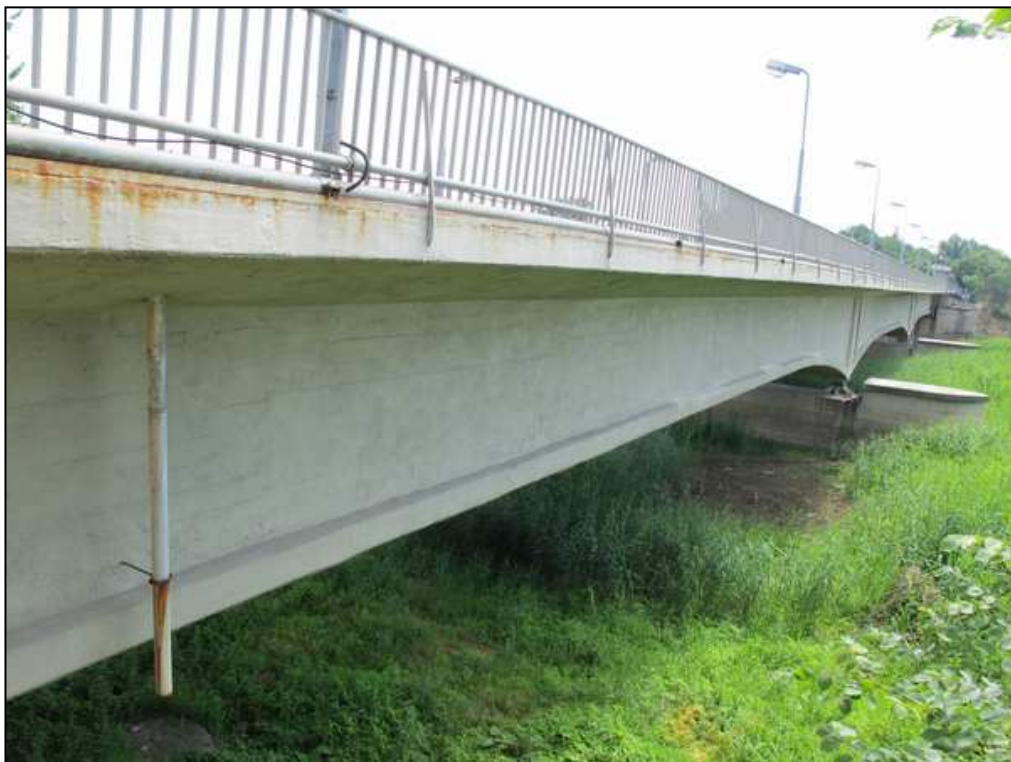
Rys. 5.5. Rdzawe zacieki występujące na całej długości gzymsów. Widok od strony Polski / dolnej wody
