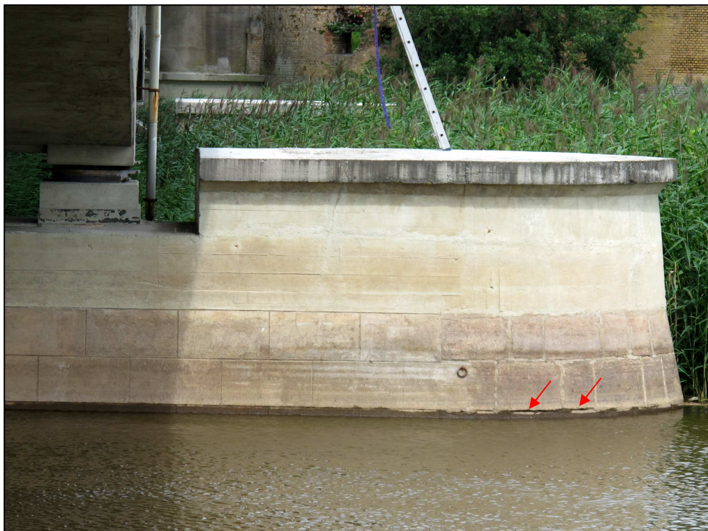
Rys. 6.11. Filar P3 od strony górnej wody. Widok w kierunku Polski. Widoczne spękania betonu górnej części korpusu. Strzałkami zaznaczono wypłukanie spoin okładziny kamiennej
