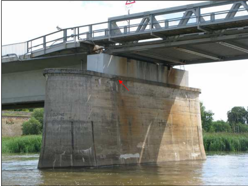
Rys. 6.14. Widok na filar P4 od strony Niemiec / dolnej wody. Widoczne liczne rysy i spękania betonu połączone z wykwitami wapiennymi. Na powierzchni ciosu podłożyskowego widoczne są rdzawe zacieki. Strzałką zaznaczono ubytek kapinosa
