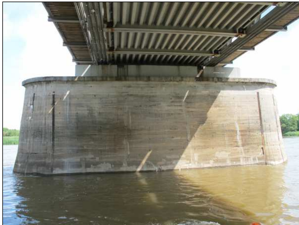
Rys. 6.20. Filar P6, widok od strony Niemiec. Widoczne są liczne spękania betonu
