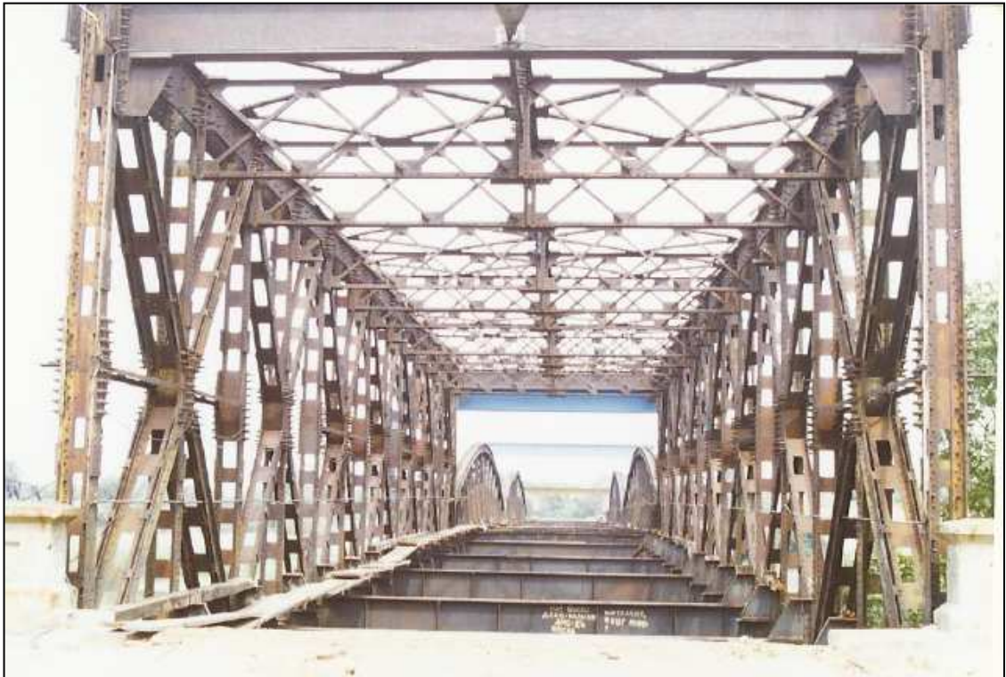
Rys. 4.11 Fotografia archiwalna obiektu z okresu przebudowy w 1992 roku. Widok skrajnego przęsła od strony Niemiec
