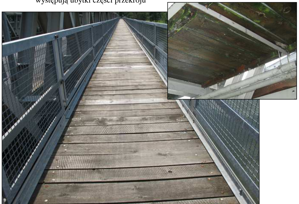
Rys. 5.17. Stan techniczny chodników jest dostateczny. Wypełnienie jest kompletne, bez ubytków. Na spodzie chodników stwierdzono lokalnie początki degradacji biologicznej drewna
