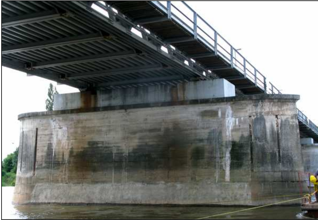
Rys. 6.17. Filar P5, widok od strony Polski / dolnej wody. Widoczne liczne zacieki i wykwyty wapienne oraz odbarwienia betonu. Na powierzchni ciosu podłożiskowego widoczne są intensywne rdzawe zacieki
