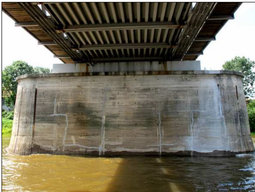
Rys. 6.19. Filar P6, widok od strony Polski. Widoczne są liczne spękania betonu
