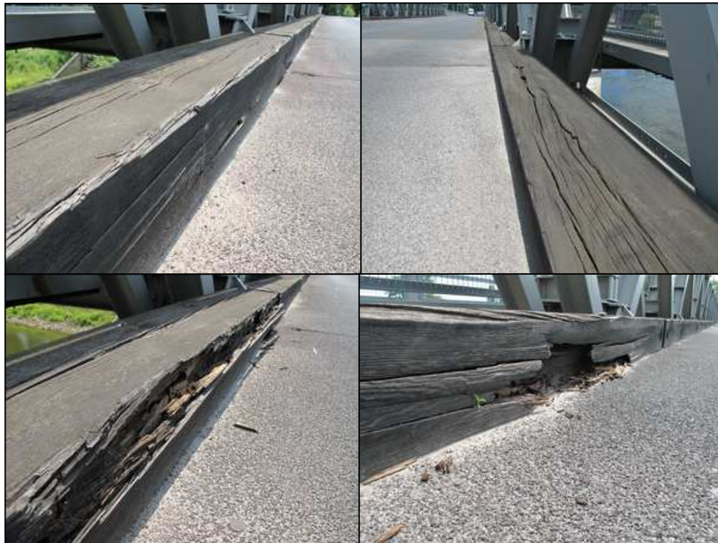
Rys. 5.16. Zły stan techniczny krawężników w części stalowej obiektu. Widoczne daleko posunięte procesy korozji biologicznej, odcinkowo występują ubytki części przekroju
