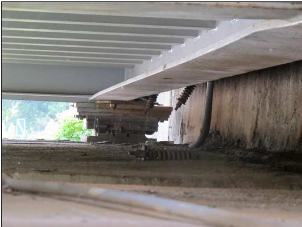
Rys. 5.19. Uszkodzenia napinaczy kasujących luzy odcinka najazdowego urządzenia dylatacyjnego oraz ich niewłaściwa regulacja powodujące powstawanie hałasu przy przejeździe pojazdów - podpora P7
