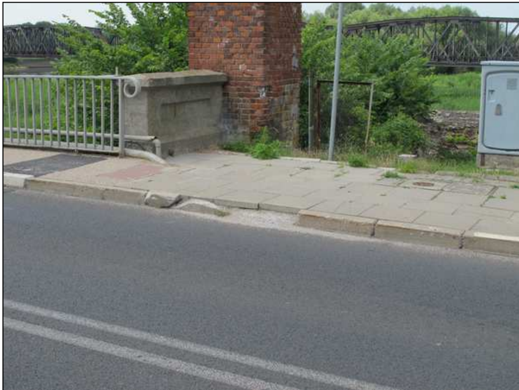
Rys. 5.4. Ubytek krawężnika na dojeździe od strony Polski / dolnej wody. Roślinność wyrastająca pomiędzy szczelinami nawierzchni z płytek betonowych.
