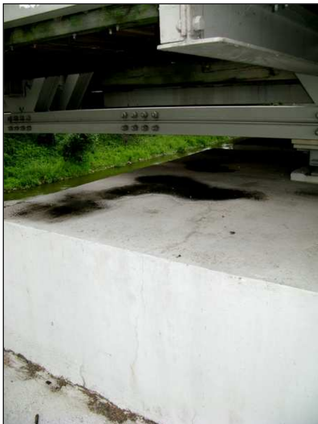
Rys. 6.21 Spękania skurczowe i korozyjne ławy podłożiskowej filara P6, zastoiska wody
