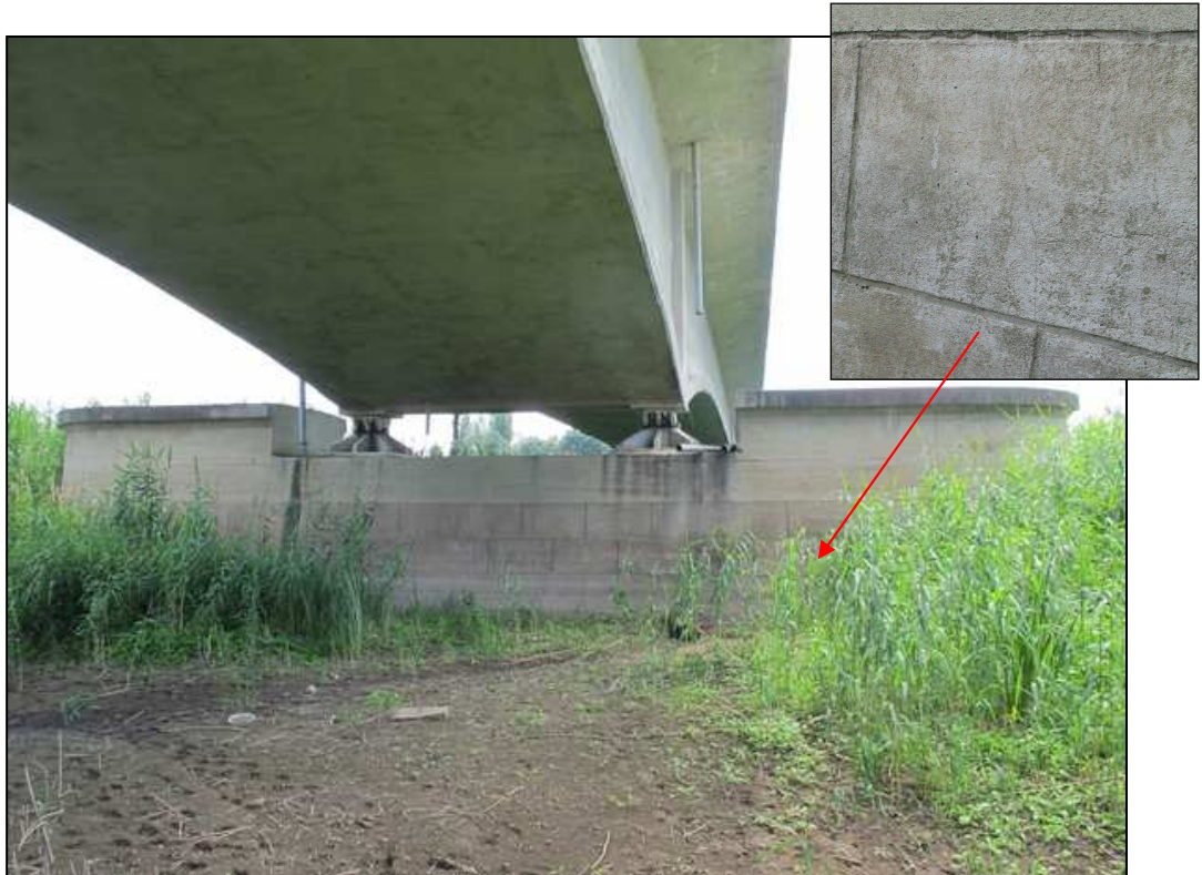
Rys. 6.6. Filar P2. Widok od strony przyczółka P1. Widoczne zacieki w sąsiedztwie niszy podłożyskowej, pochodzące z niewłaściwie wykonanego odwodnienia; zbliżenie na spękania oblicówki
