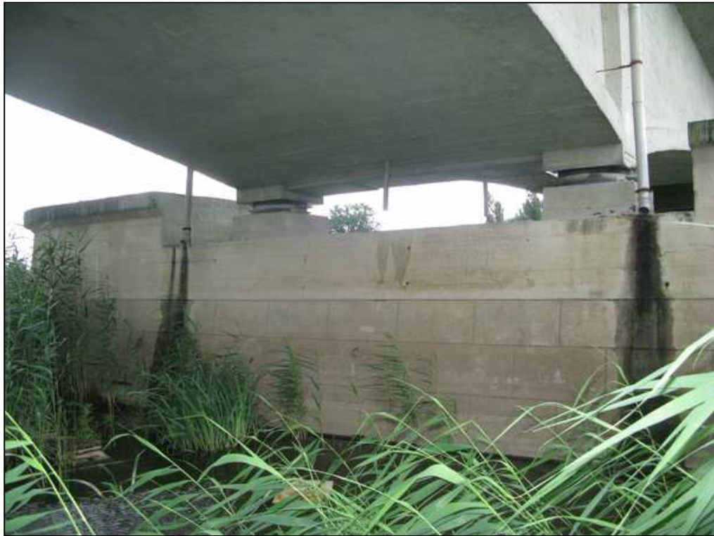
Rys. 6.10. Filar P3. Widok od strony Polski. Widoczne wilgotne zacieki na korpusie powstałe w wyniku zamontowania zbyt krótkich rur spustowych odwodnienia przęsła
