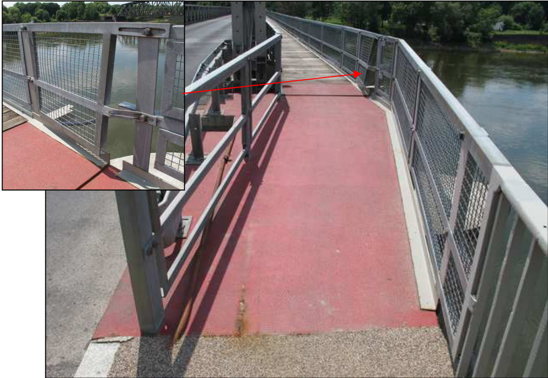
Rys. 5.18. Nawierzchnia odcinka przejściowego między przęsłami żelbetowymi a stalowymi, od strony dolnej wody. Występują drobne starcia nawierzchni oraz zacieki korozyjne. Widoczne jest również mechaniczne uszkodzenie jednego przęsła balustrady.
