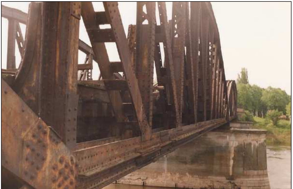
Rys. 4.12 Fotografia archiwalna z okresu poprzedzającego przebudowę obiektu w 1992 r. Widok na przęsła stalowe. Widoczna daleko posunięta degradacja konstrukcji przęseł i filarów
