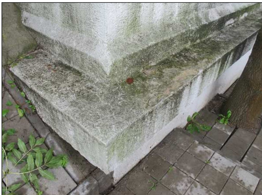
Rys. 6.26. Spękania i ubytki warstw naprawczych przyczółka. Odsadzka od strony górnej wody
