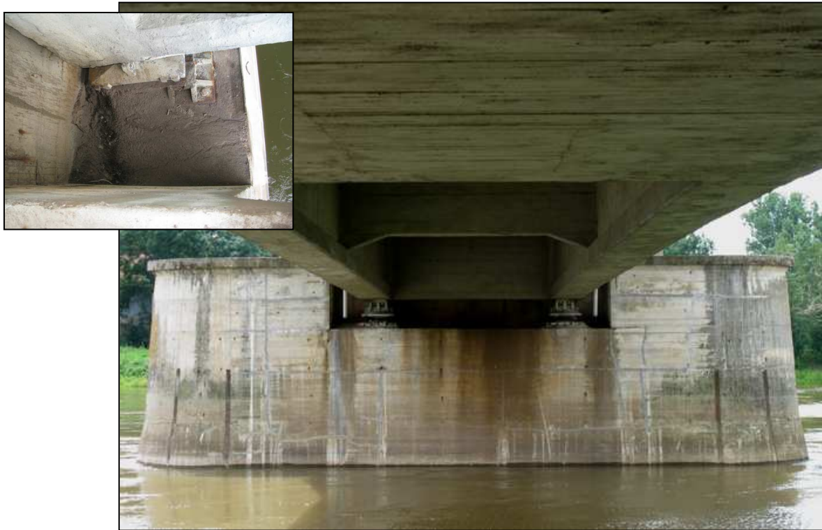
Rys. 6.12. Widok na filar P4 od strony Polskiej. Widoczna głęboko wcięta nisza podłożyskowa. Na powierzchni filara widoczne liczne spękania betonu, wykwitły wapienne oraz zanieczyszczenie betonu. Widoczne również rury spustowe wprowadzające wodę opadową na niszę. Po lewej - zanieczyszczenie niszy podłożyskowej od strony polskiej piaskiem z pomostu. Widoczne łożysko stałe od strony górnej wody
