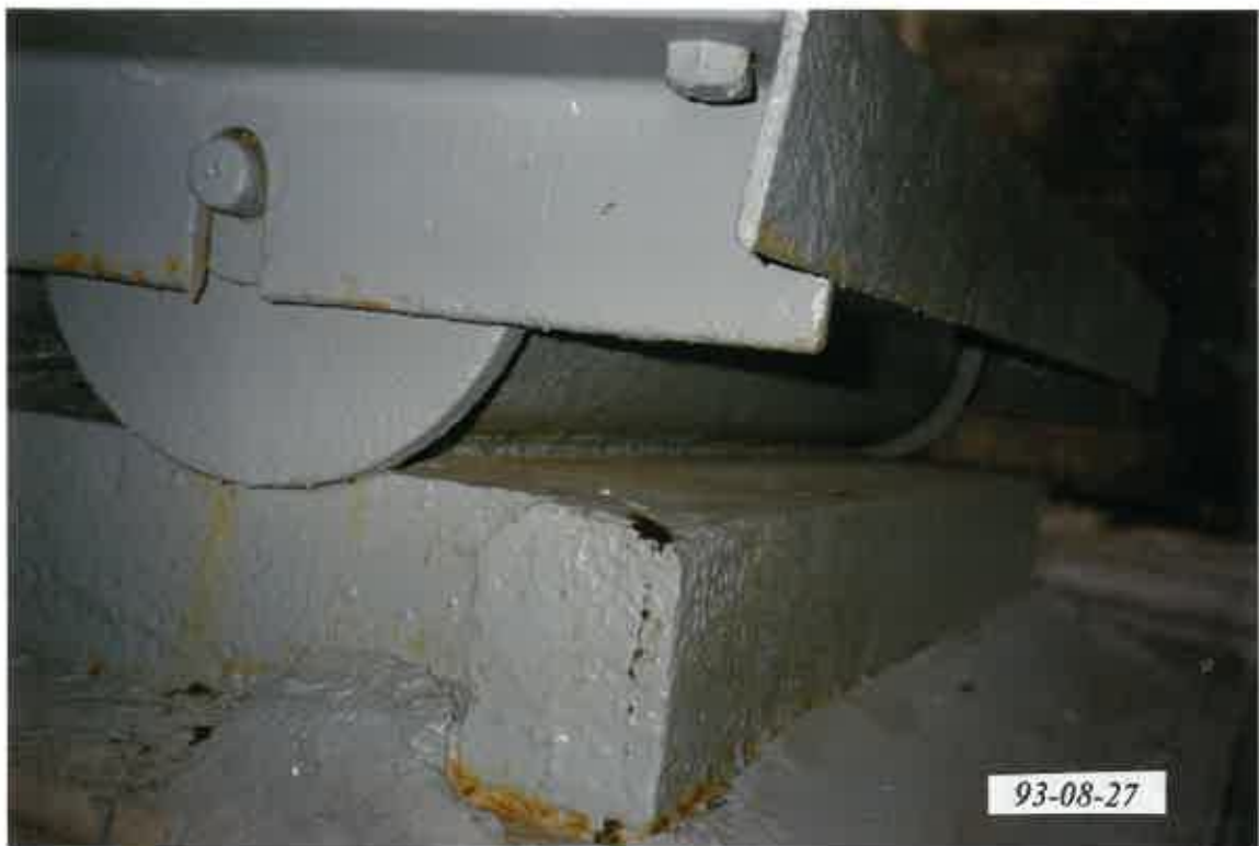
Rys. 4.4 Widok wałka łożyska ruchomego na przyczółku od strony RP - widoczny brak przesuwu wałka od czasu jego malowania
