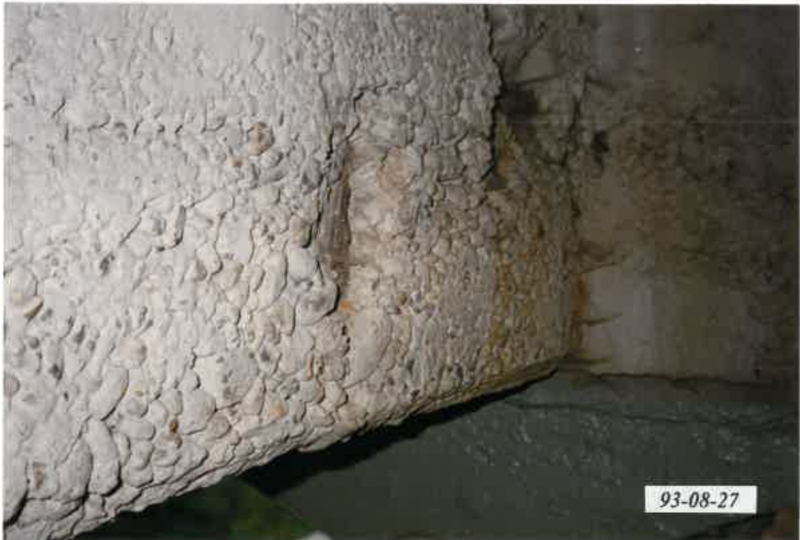
Rys. 4.3 Rozwarstwienie betonu poprzecznicy podporowej - przyczółek od strony RP
