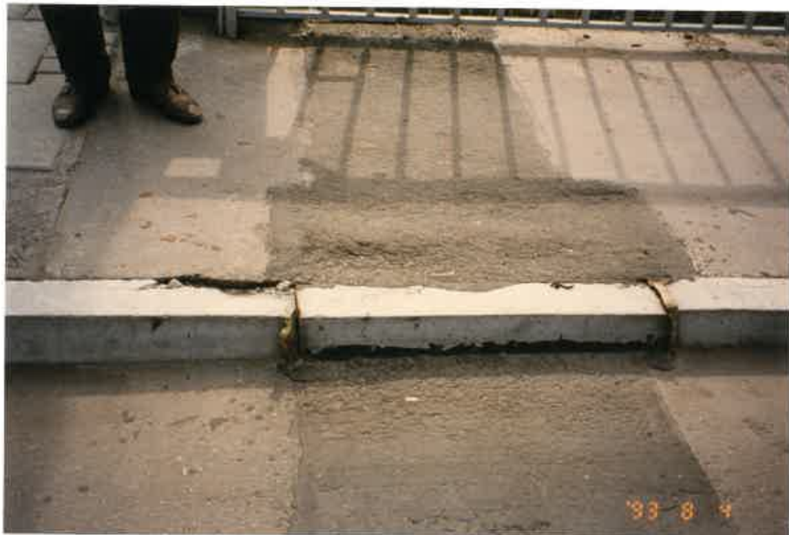
Rys. 4.6 Widok uszkodzeń krawężnika w rejonie przykrycia dylatacyjnego typu TARCO od strony wody górnej
