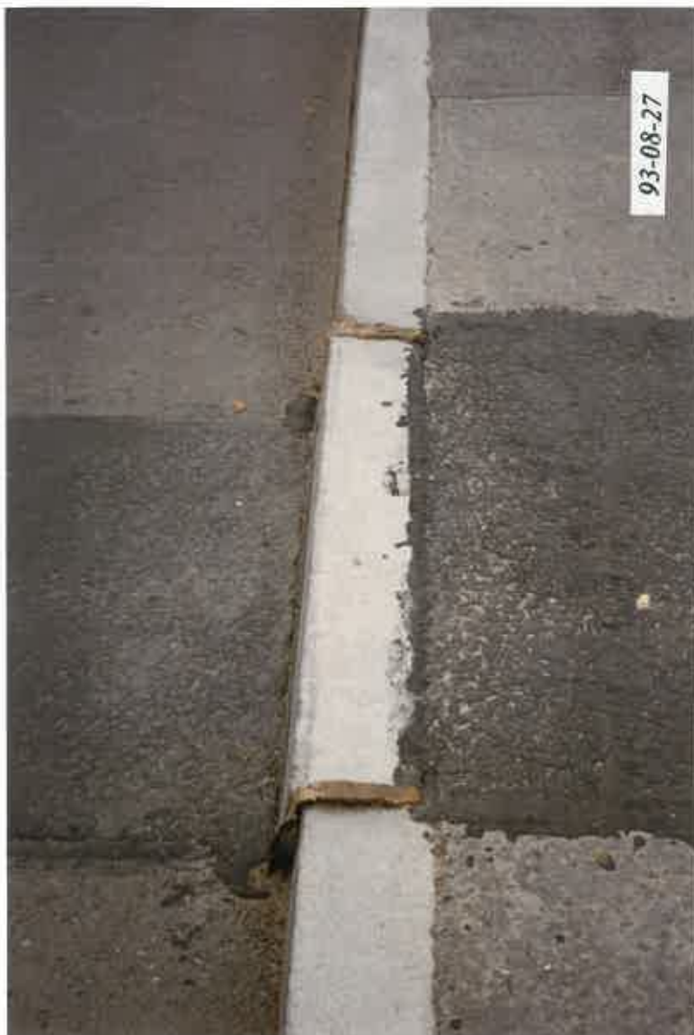
Rys. 4.7 Wypchnięcie krawężnika w kierunku jezdni w obrębie przykrycia dylatacyjnego od strony wody dolnej
