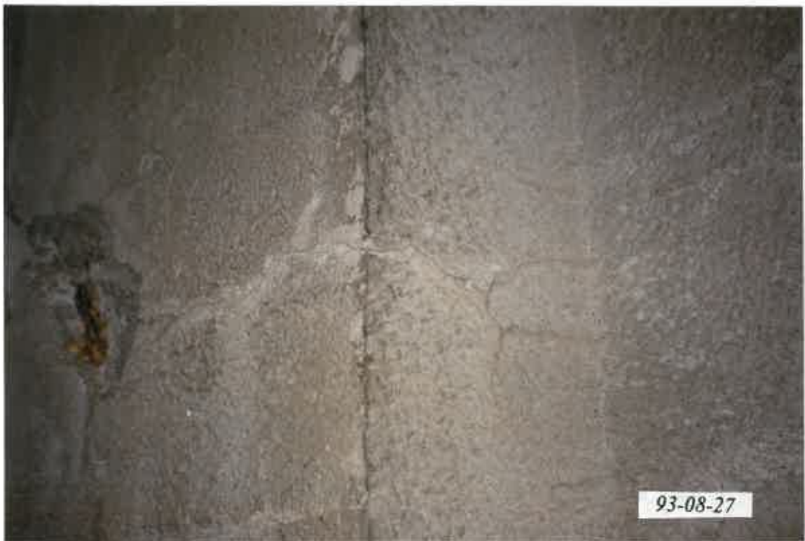
Rys.4.2 Widok rys na powierzchni bocznej dźwigara - nad przyczółkiem od strony RP
