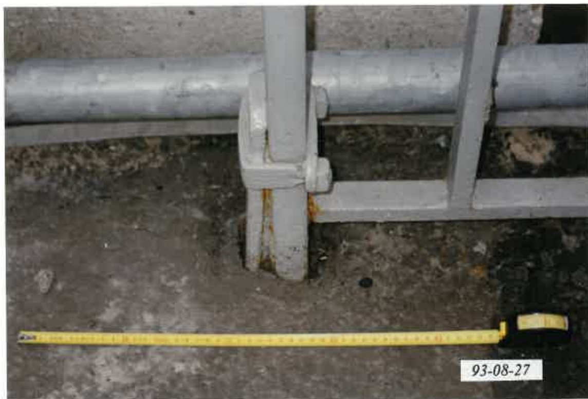
Rys. 4.8 Widok uszkodzenia zamocowania słupka poręczy przy przyczółku od strony wody górnej
