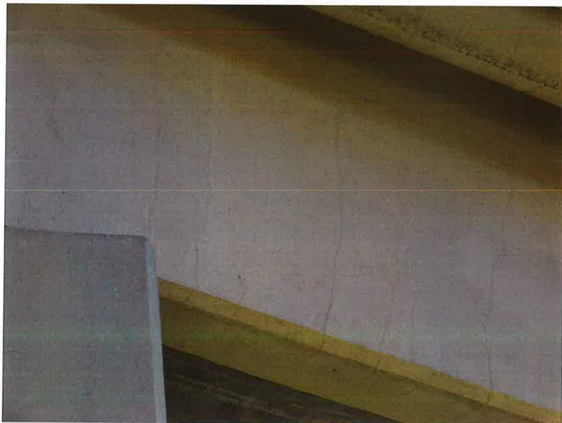
Fot. 20. Rysy poprzeczne na ścianie bocznej dźwigara głównego nad filarem.
