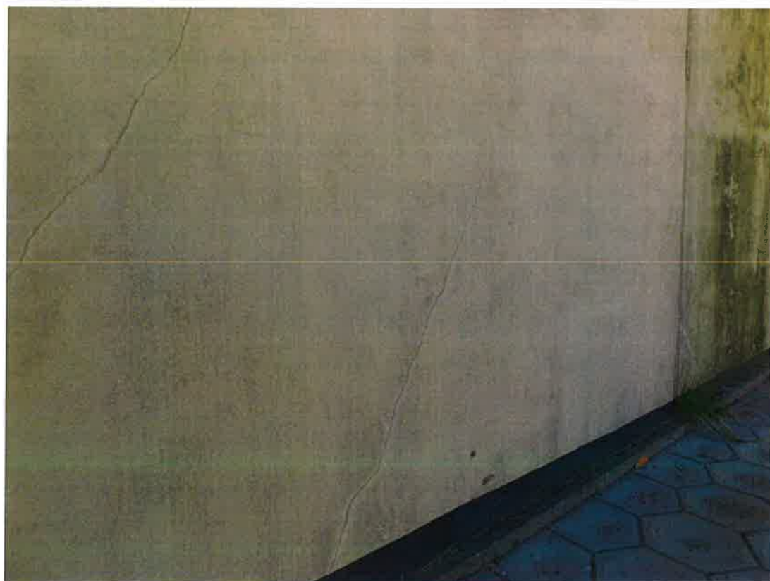
Fot. 18. Zanieczyszczenie oraz zarysowania na przyczółku (podpora nr 3).
