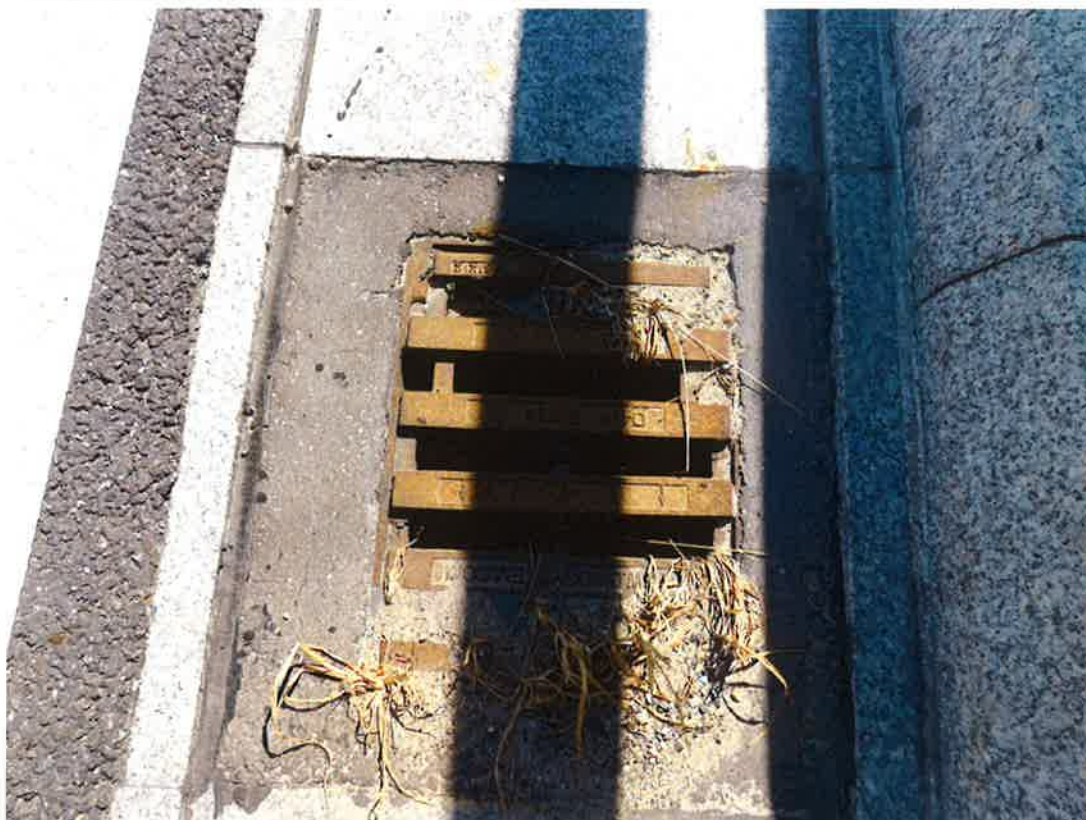
Fot. 11. Zanieczyszczenie kratki wpustu.
