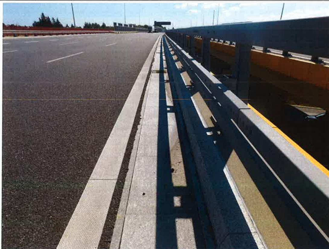
Fot. 12. Zanieczyszczenie ścieku przykrawężnikowego.
