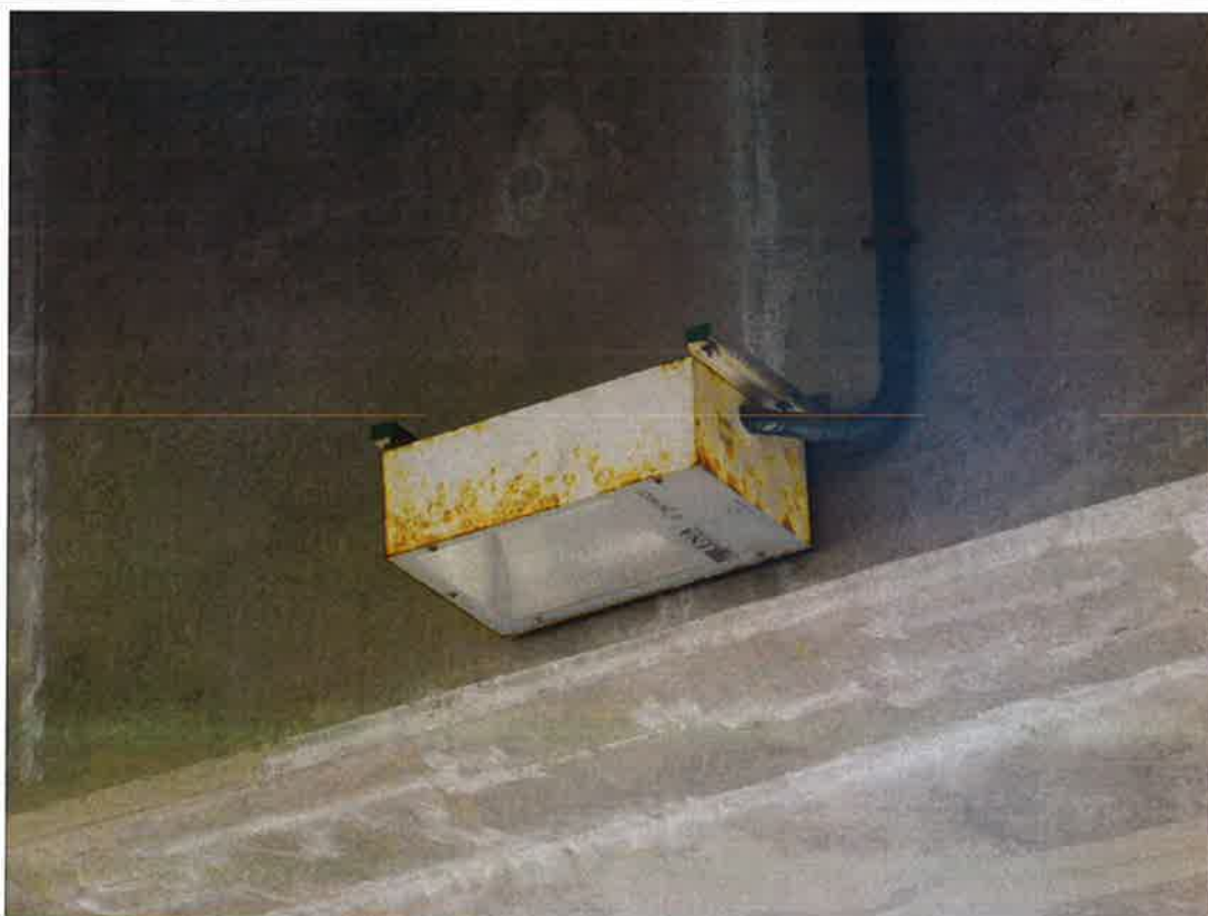
Fot. 22. Zniszczenie zabezpieczeń antykorozyjnych i ogniska korozji stalowej osłony lampy.
