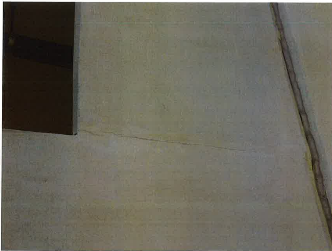
Fot. 15. Zarysowanie na ścianie zapleczej przyczółka (podpora nr 1).
