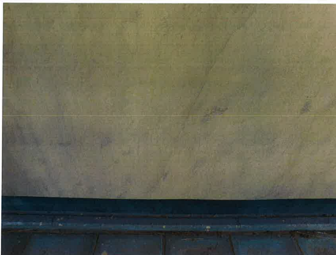
Fot. 16. Zanieczyszczenie oraz zarysowania na przyczółku (podpora nr 1).
