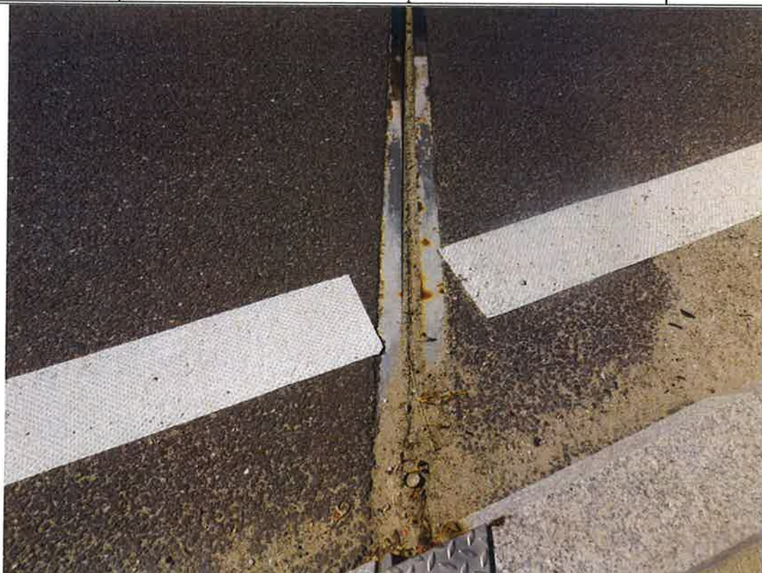
Fot. 13. Zanieczyszczenie, ubytki zabezpieczenia antykorozyjnego oraz ogniska korozji urządzenia dylatacyjnego. Uszkodzenie typowe dla całego obiektu.
