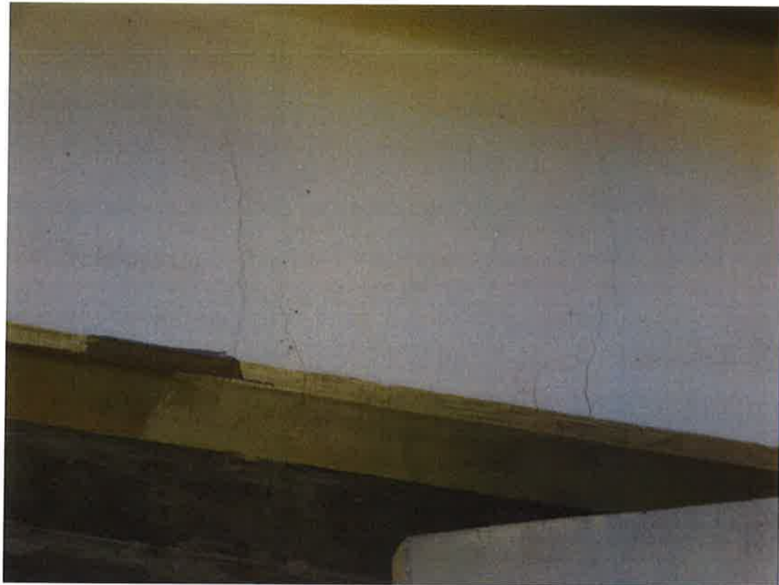
Fot. 19. Rysy poprzeczne na ścianie bocznej dźwigara głównego nad filarem.
