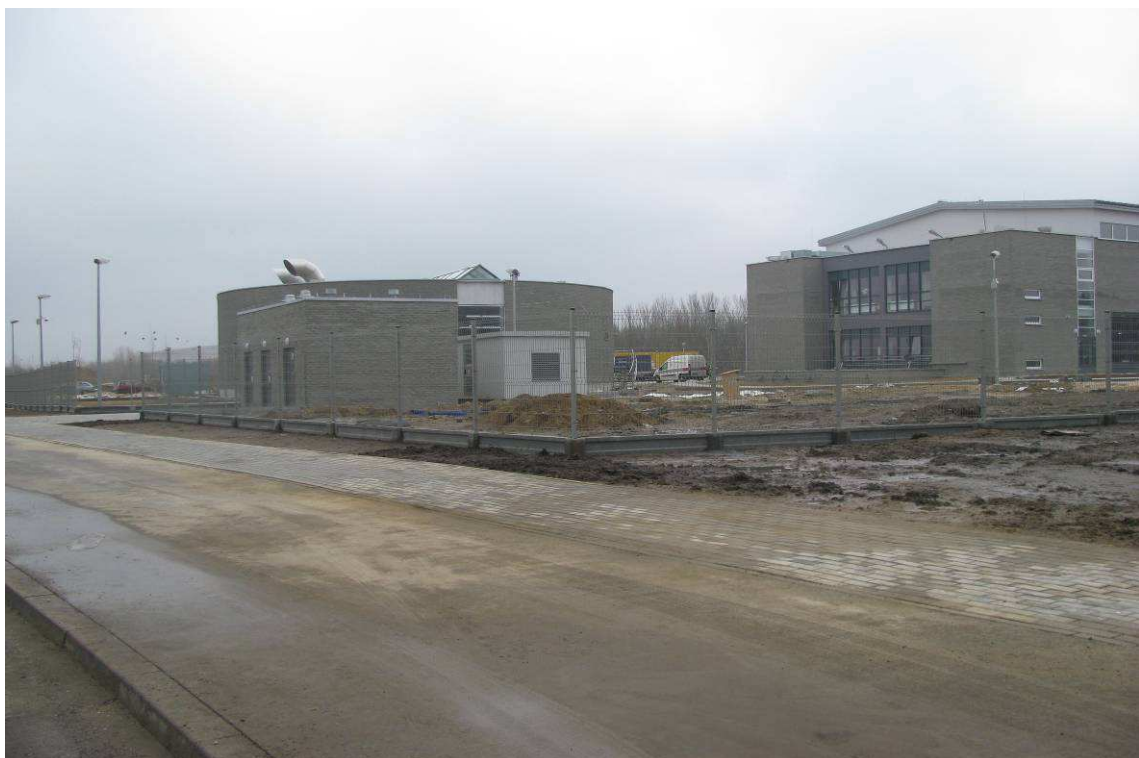
Fotografia 10 Przepompnia oczyszczalni ścieków „Czajka” zlokalizowana na lewym brzegu Wisły w rejonie wariantu I/I.1
