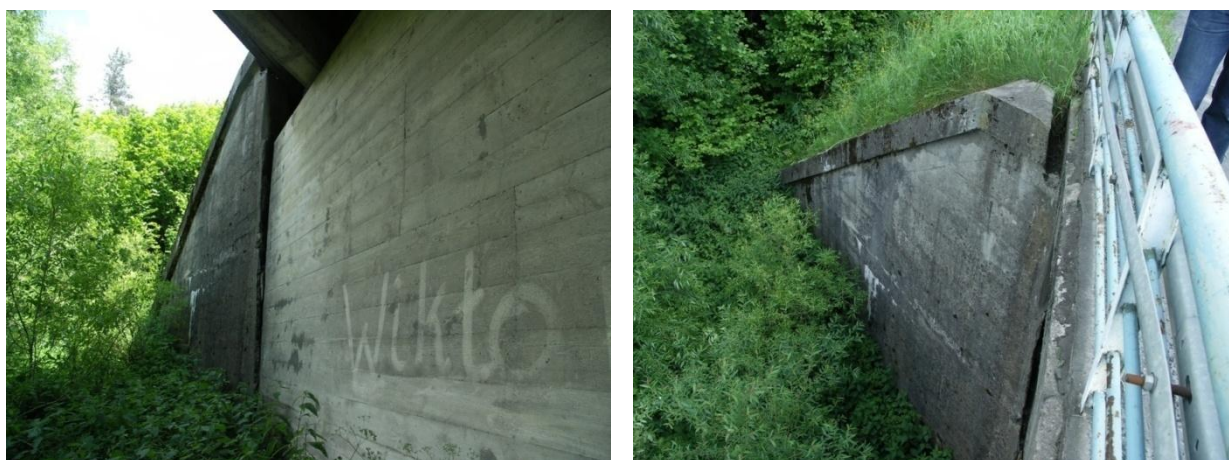
Rys. 4.9. Żelbetowa konstrukcja oporowa obok żelbetowego przyczółka – w ewidencji nie powinna figurować jako osobny drogowy obiekt inżynierski
