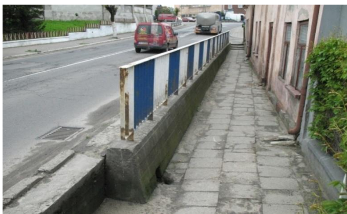
Rys. 4.3. Wzmocnienie krawędzi jezdni (długość 20 m, wysokość 0.6 m). Obiekt nie będzie figurował jako osobny drogowy obiekt inżynierski.
