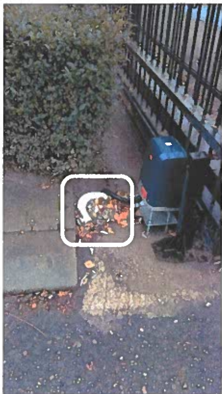
Zdjęcie nr 1. Przyłącze energii elektrycznej.
